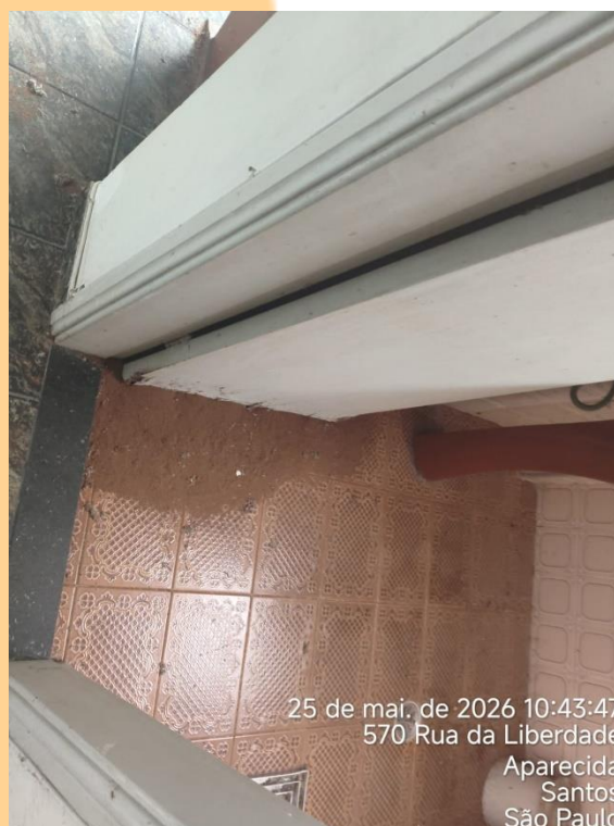
Vista do dano da porta do banheiro social
