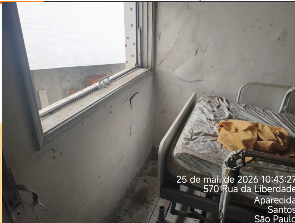
Vista quarto 02 problemas patológicos de deterioração de reboco e acabamentos
