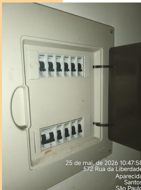
Sistema disjuntor elétrico modernizado
