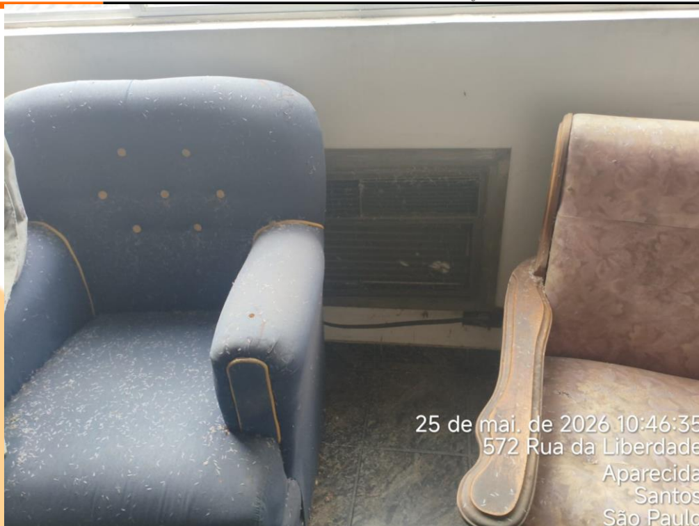
Sistema de ar condicionado antigo
