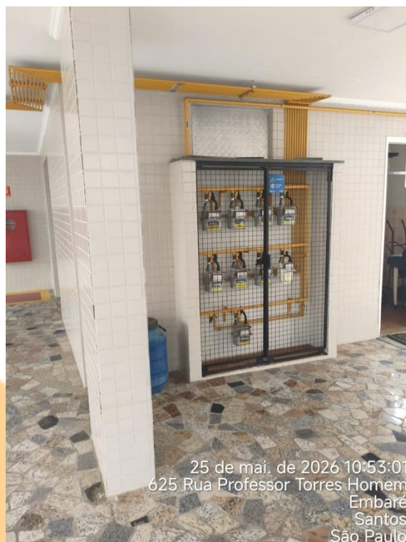
Sistema de gás canalizado
