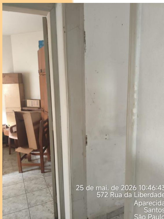
Porta do quarto faltando porta
