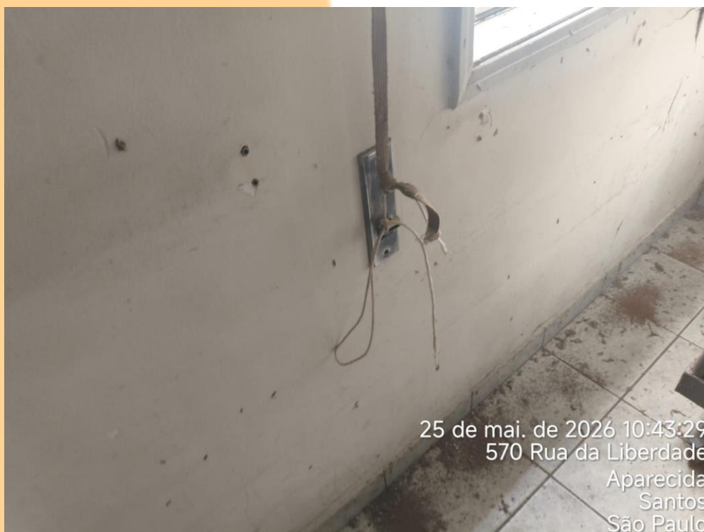
Dano janela do quarto 02
