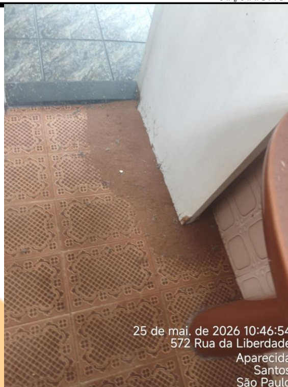
Danos de cupim nos madeiramentos interno ao imóvel
