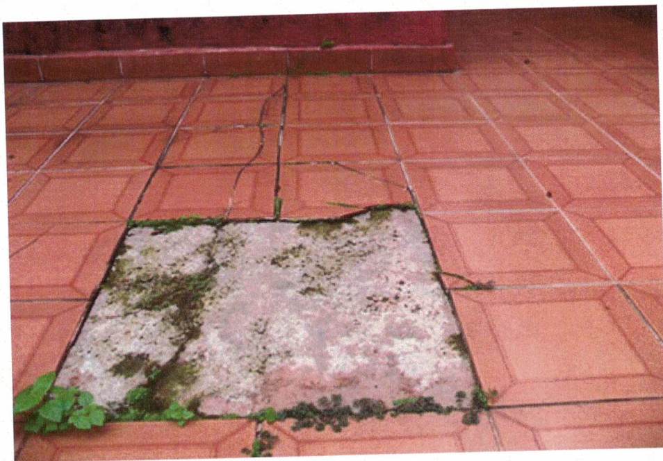
Foto 10: Infiltração e Piso Quebrado do Quintal do Fundo da Casa
