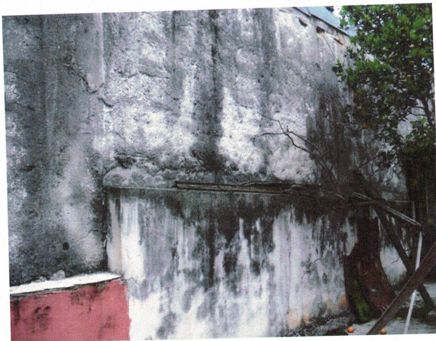
Foto 12: Infiltração da Parede Lateral do Quintal do Fundo da Casa
