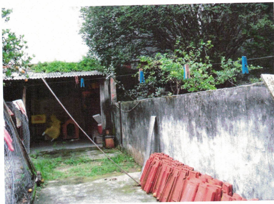
Foto 13: Infiltração da Parede Lateral do Quintal do Fundo da Casa
