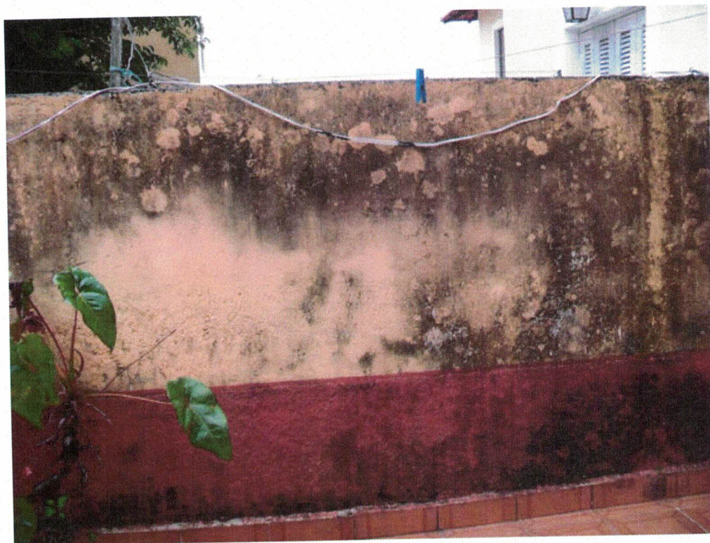
Foto 11: Infiltração da Parede Lateral do Quintal do Fundo da Casa
