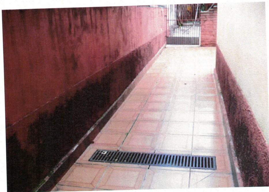
Foto 14: Infiltração da Parede do Corredor de Acesso ao Quintal do Fundo da Casa
