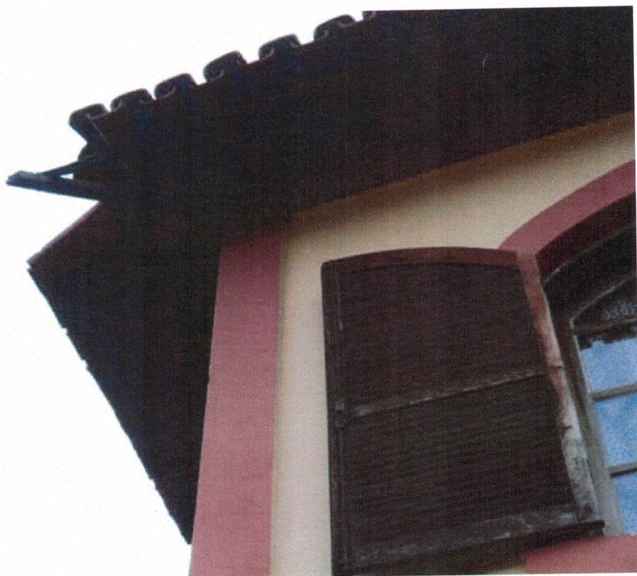
Foto 7: Telhado Quebrado da Frente da Casa
