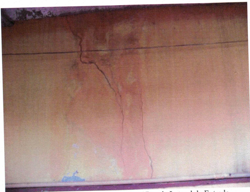
Foto 4: Rachaduras e Infiltração na Parede Lateral de Entrada
