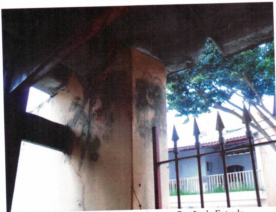
Foto 3: Infiltração e Rachaduras no Portão de Entrada
