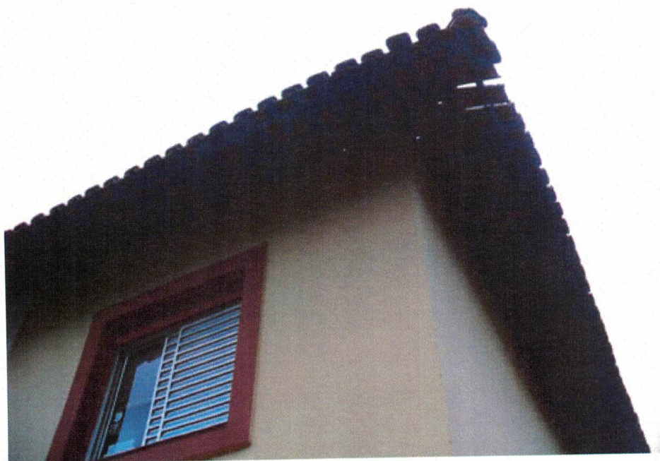
Foto 9: Telhado Quebrado do Fundo da Casa
