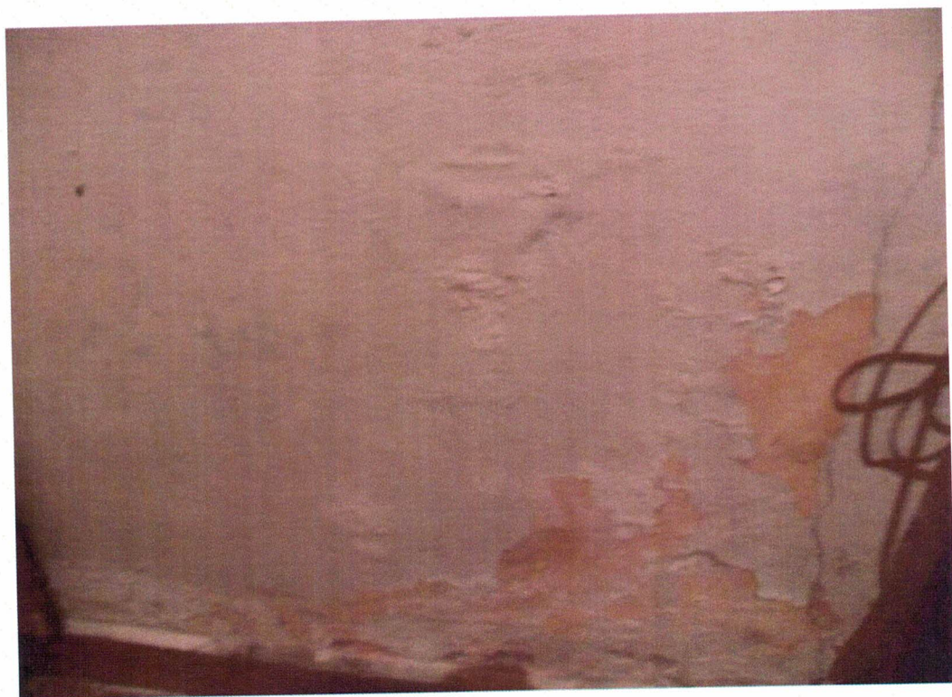
Foto 15: Infiltração da Parede do Quarto de Empregada
