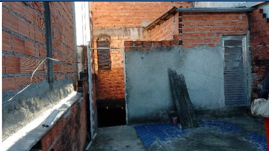
FOTO – Casa 02 - Paredes avariadas
