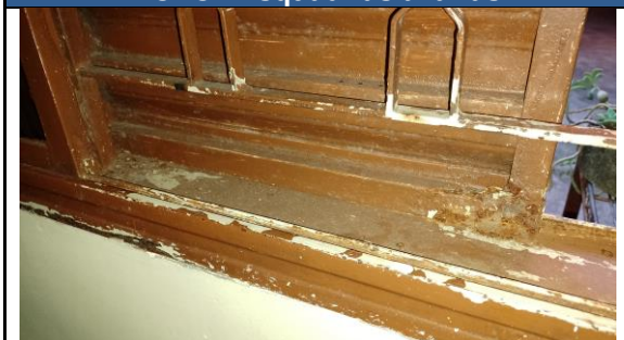
FOTO –Esquadrias avarias
