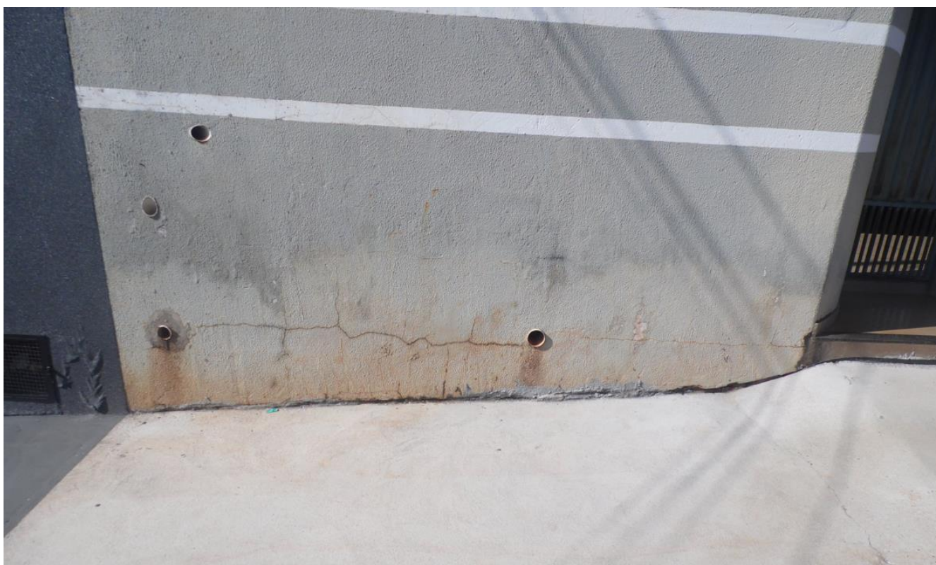
Imagem 15 –Na parte frontal foi constatado a presença de fissuras, no entanto, são patologias de pequena gravidade, que só precisam de reparos adequados para serem eliminadas.
