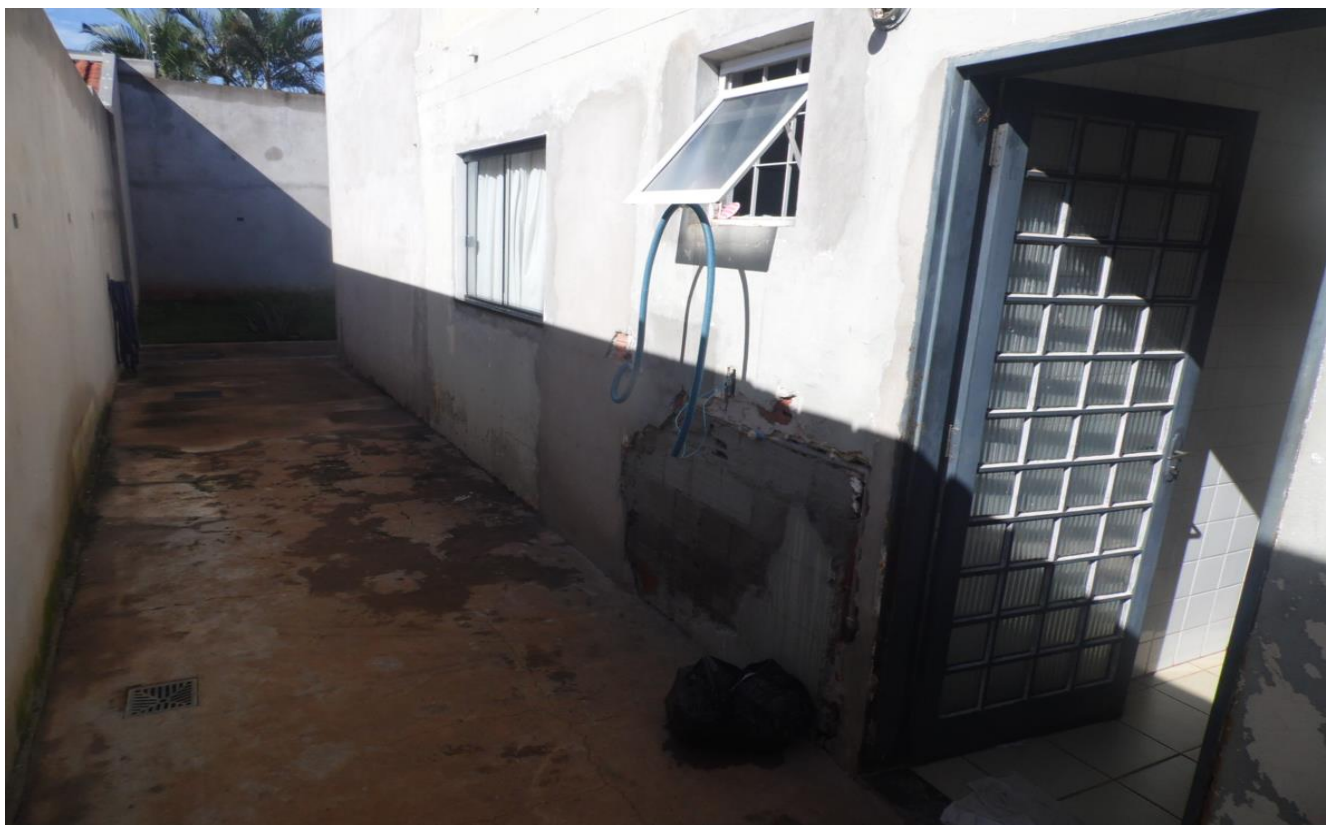
Imagem 04 – Lateral esquerda - na parede externa da Cozinha foram constatadas patologias relacionadas a uma adequação hidráulica, a serem revisadas durante a conclusão das obras.
