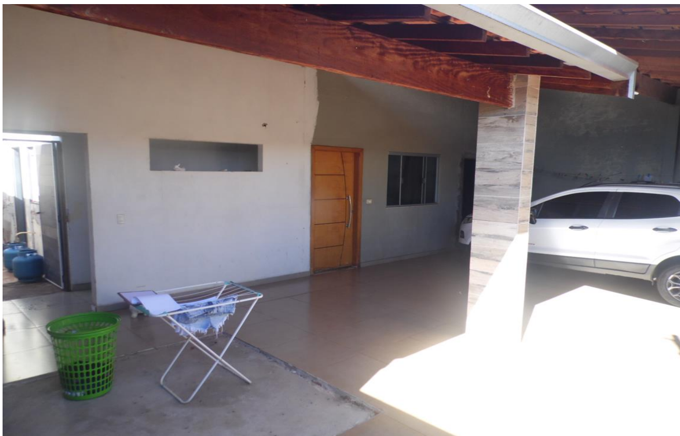
Imagem 03 – Abrigo de Veículos - área para 02 veículos com estrutura de madeira, cobertura em telhas de barro, sem forração e pisos cerâmicos, precisando de uma revisão na pintura.
