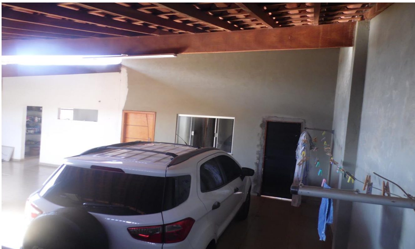
Imagem 02 – Abrigo de Veículos - área para 02 veículos com estrutura de madeira, cobertura em telhas de barro, sem forração e pisos cerâmicos, precisando de uma revisão na pintura.
