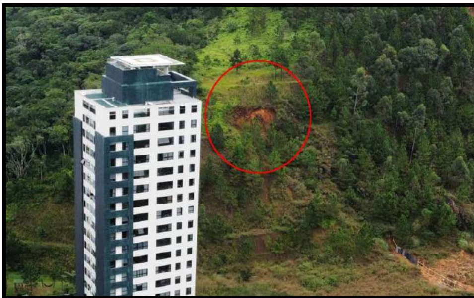
Detalhe de trecho com deslizamento aparente.
