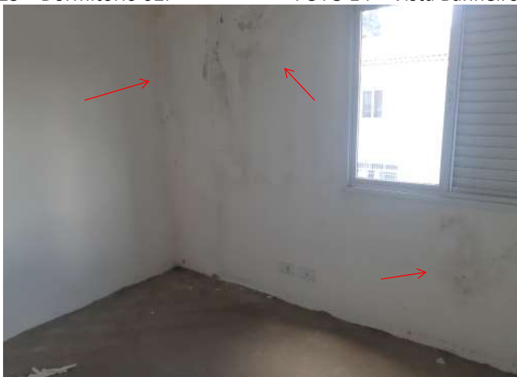
- FOTO 15 – Vista do Dormitório 03. Nota-se, conforme indicação das setas, pontos de infiltração provindos do forro e da janela.
