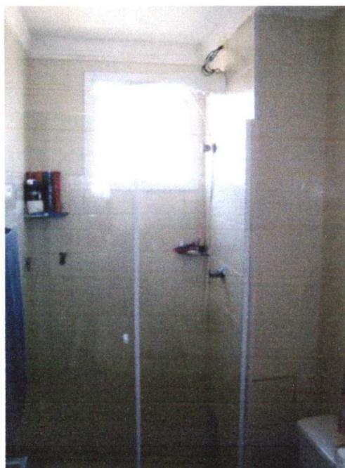
Foto nº 31- Vista parcial do box do banheiro
