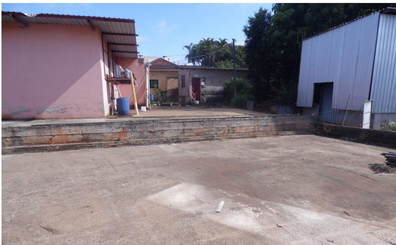
Imagem 06 – Neste cenário, na avaliação no imóvel foi considerado somente o valor da área do Terreno, excluindo-se, portanto, o valor correspondente a remoção desta fração construída.
