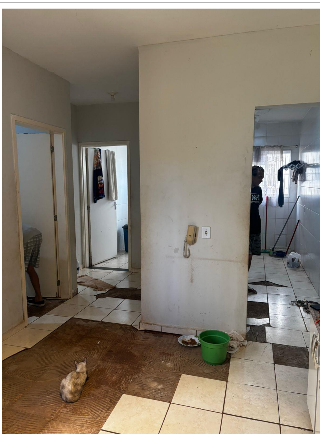
FOTO 03 – Vista da sala do imóvel. Nota-se a falta de piso em diversos pontos
