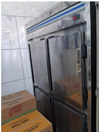
Item 1 — mini câmara fria inox (foto dos autos, abr/2025)
