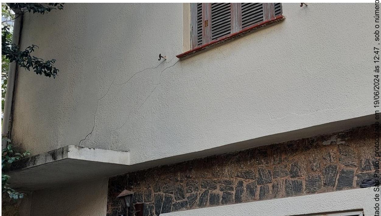
Vista das trincas mostradas na fotografia anterior na fachada da casa.
