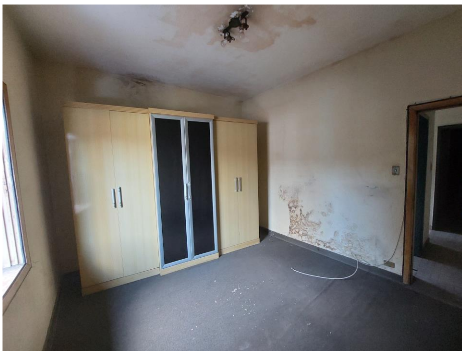
Dormitório de frente. Atrás deste armário encontra-se um banheiro inacabado.
