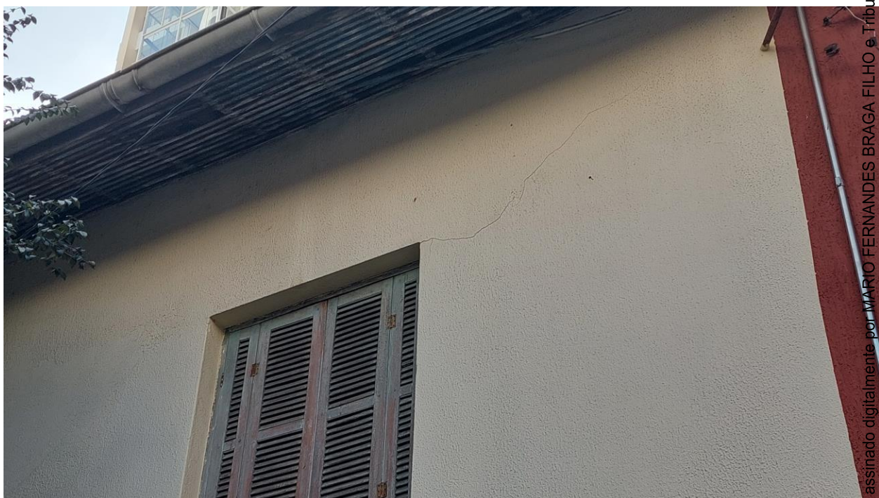
Trincas na fachada da casa, na parte superior da janela mostrada nas fotos anteriores.
