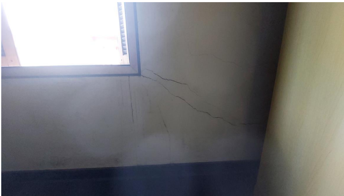
Trincas inclinadas junto à janela do dormitório da frente.
