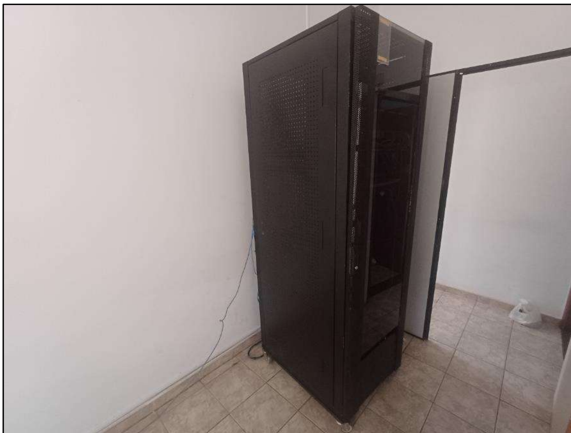
ITEM 050 - RACK COM SWITCH
