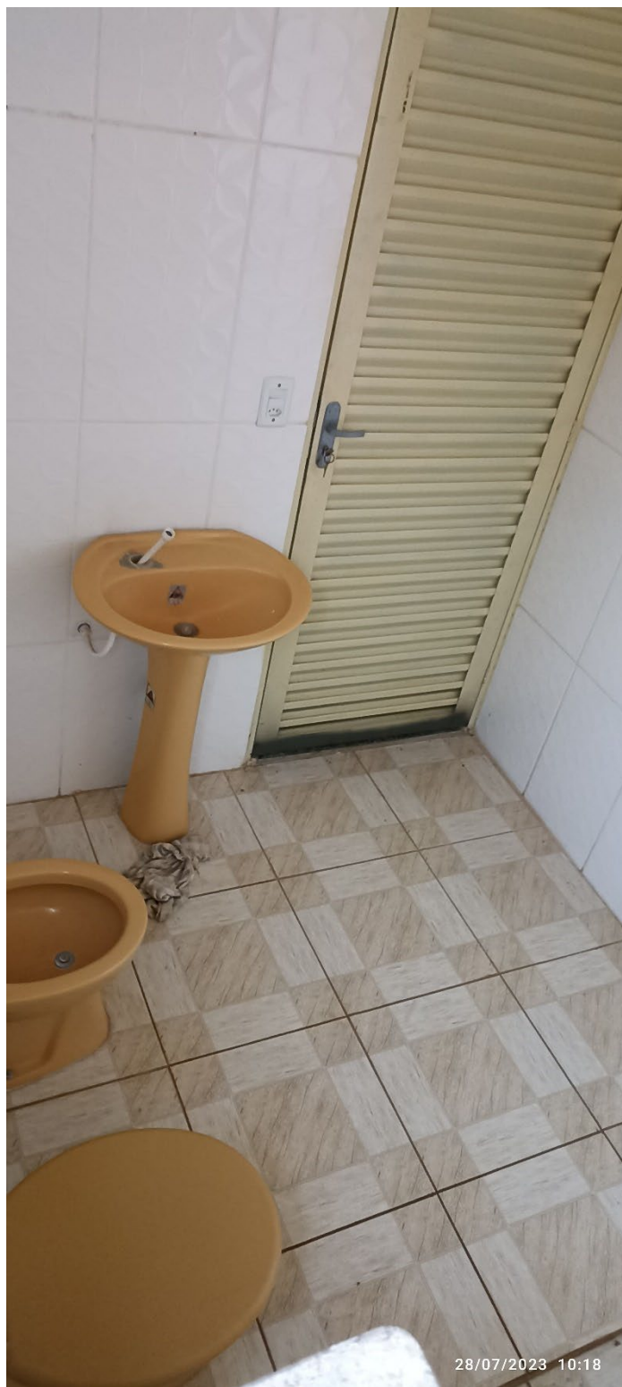
Foto 8 - Banheiro sem metais sanitários
