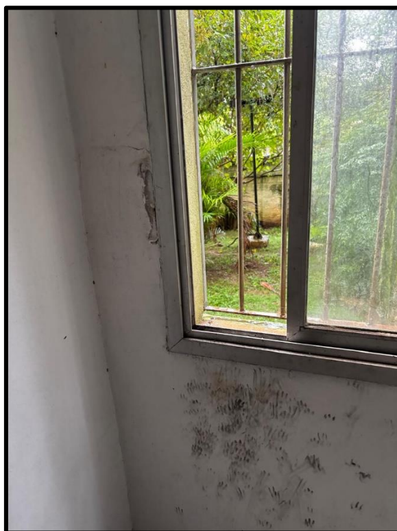
Foto 12: Vestígio de infiltração de água na parede
