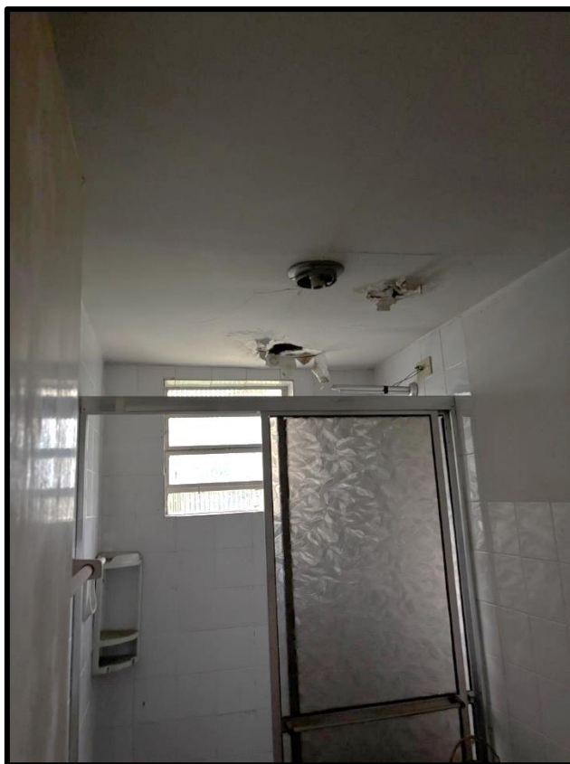
Foto 15: Banheiro - vestígio de vazamento no teto
