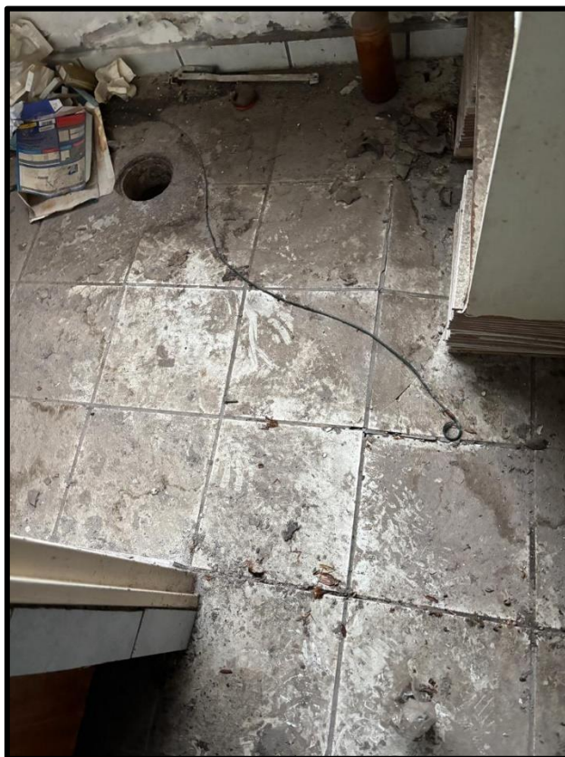
Foto 9: Piso, quebrado e solto
