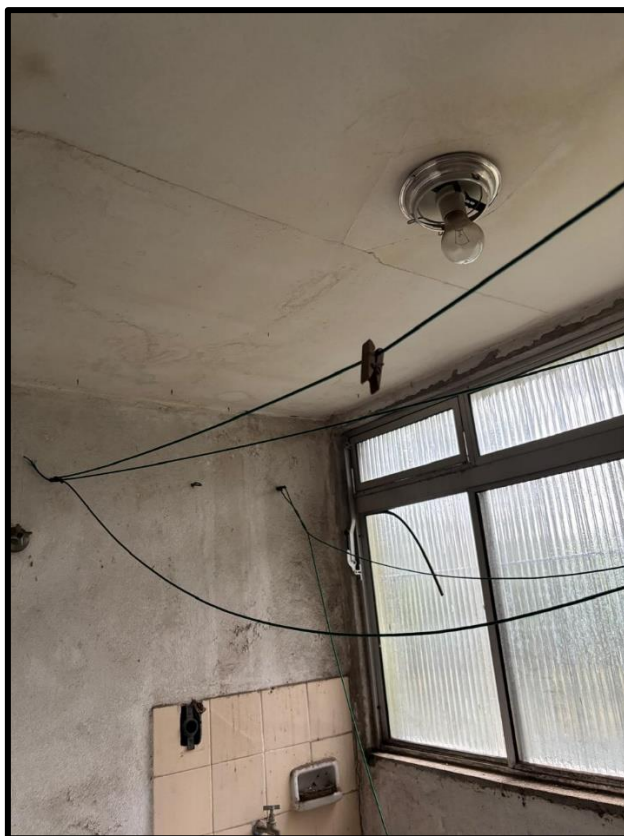
Foto 10: Parede e teto com vestígio de infiltração
