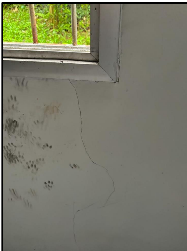
Foto 23: Trinca na parede
