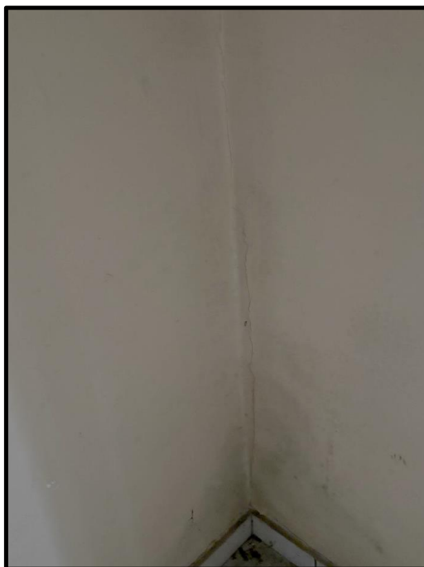
Foto 32: Trinca na parede
