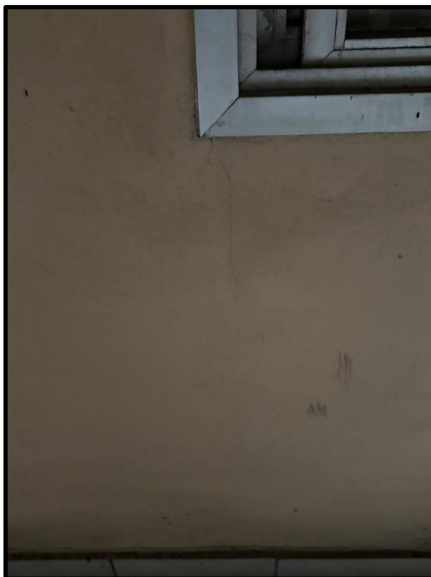
Foto 33: Trinca na parede
