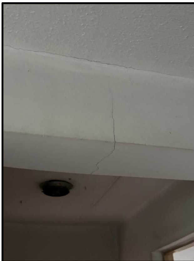
Foto 13: Trincas no teto
