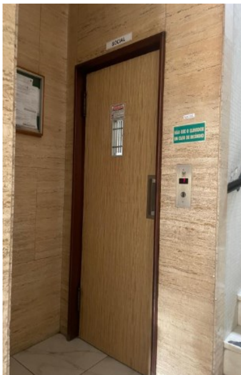
FOTO Nº 04 Vista parcial elevador social
