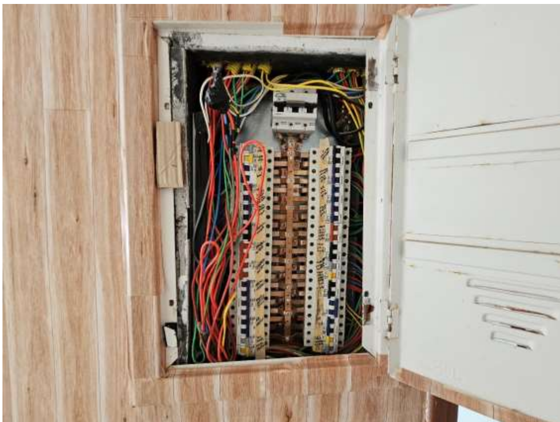
77 – Pavimento Superior – Quadro elétrico
