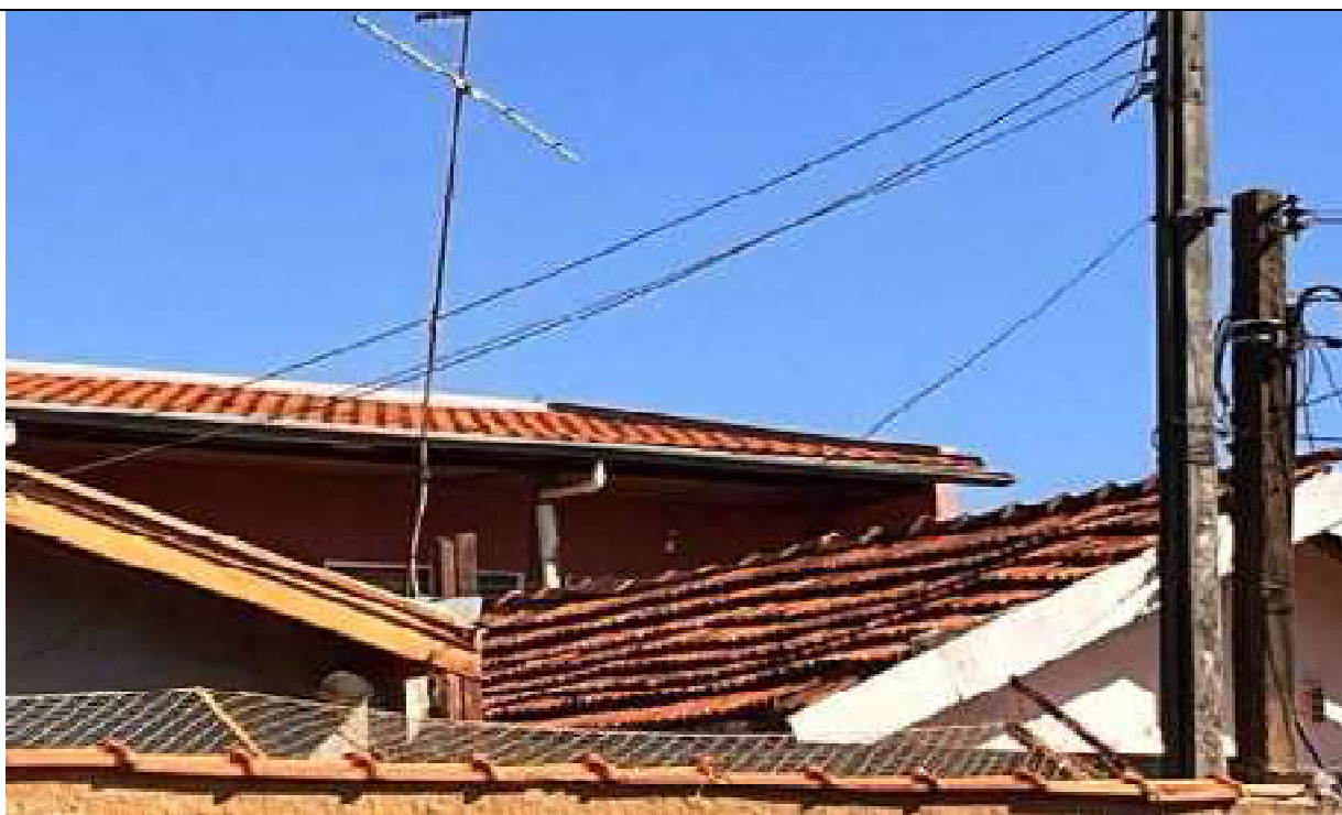
Foto 5: Vista do telhado onde se observa problemas de ondulações que acarretam infiltrações de águas pluviais.
