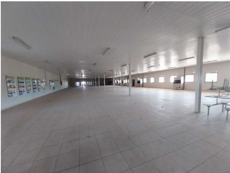
CLIMATIZADORES REFEITÓRIO - CINCO UNIDADES
