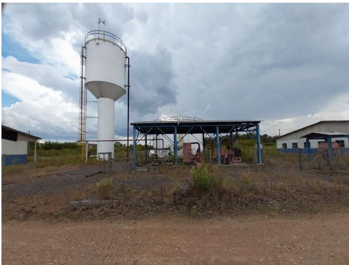
CAIXAS D'ÁGUA E SISTEMA DE COMBATE A INCÊNDIO
