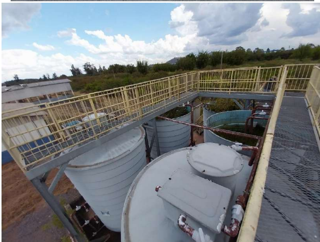
RESERVATÓRIOS DE ARMAZENAMENTO DA ESTAÇÃO DE TRATAMENTO
