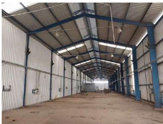
Vistas da área externa, área interna (Aço Carbono e Aço Inox)
