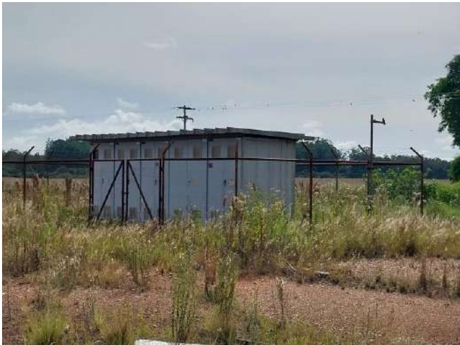
Vista Geral da Subestação
