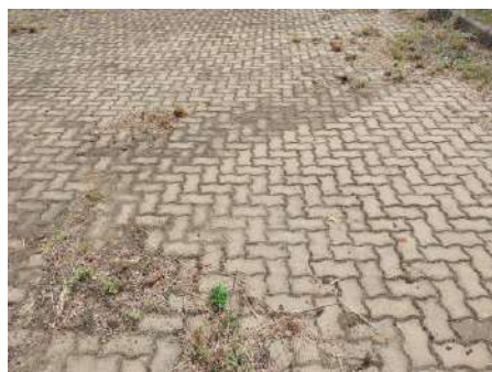
Condições da Pavimentação em Piso Intertravado
