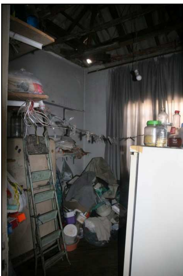
FOTOS 15/16 - Despensa. O forro da despensa ruiu.
