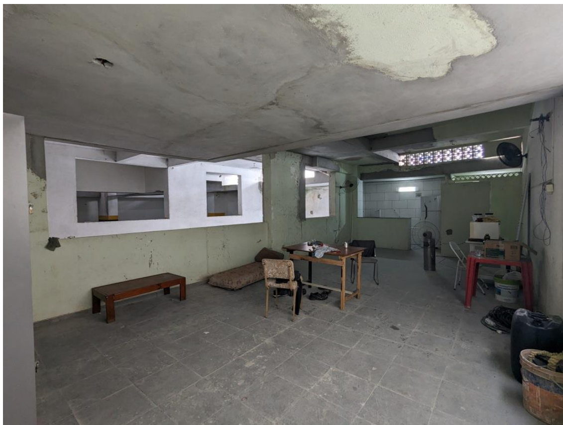
Foto 16 – Vista interna do salão de festas do condomínio; notam-se alguns reparos no teto e nas paredes.
