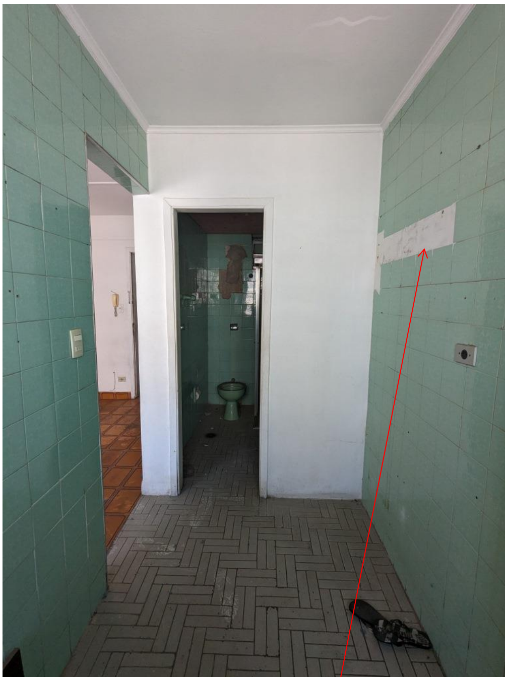
Foto 12 – Vista em sentido contrário da foto anterior; ao fundo o banheiro; faltam azulejos na parede
