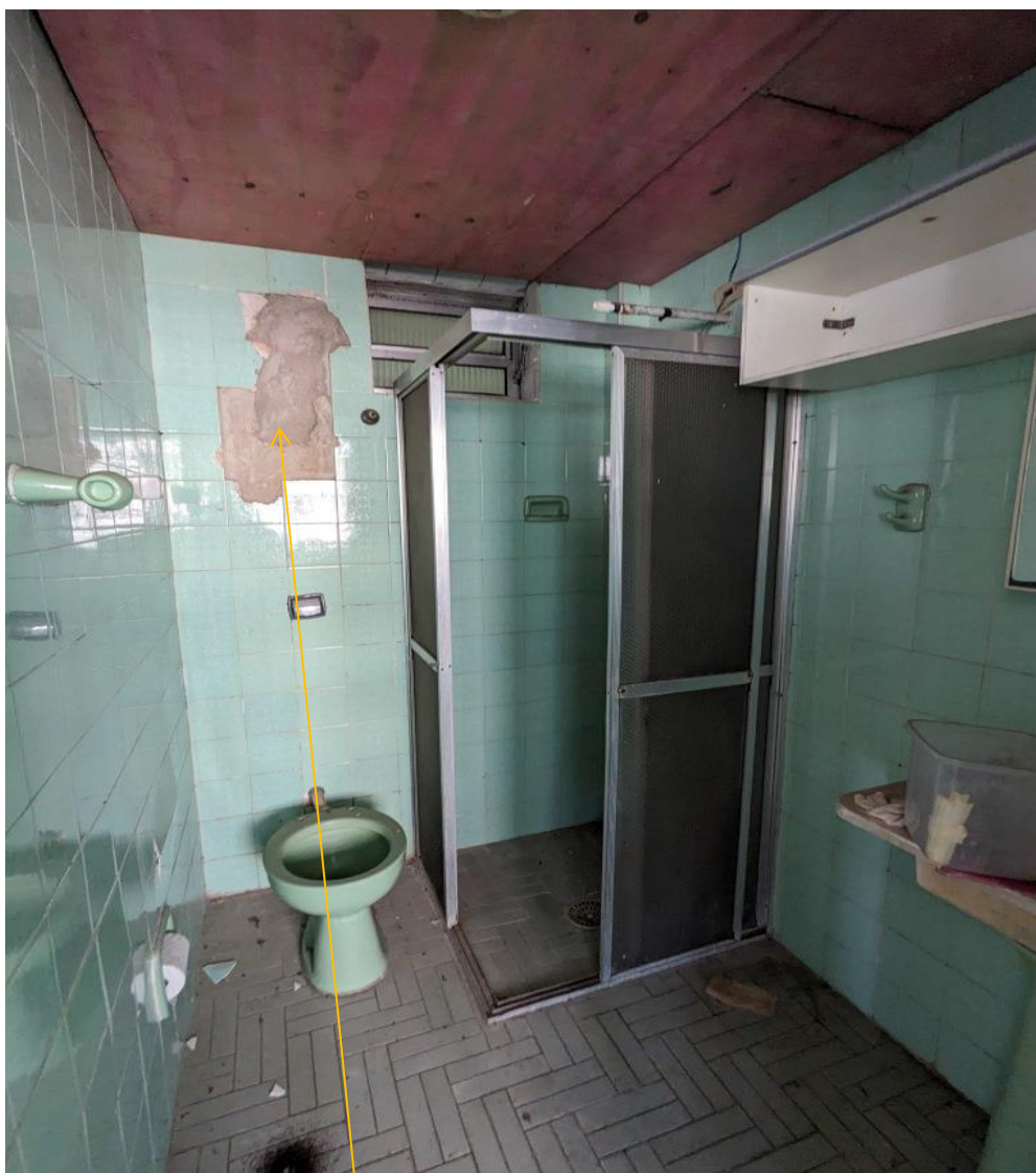
Foto 13 – Banheiro está com forro de chapa compensada, de forma improvisada; revestimentos de azulejos danificados
