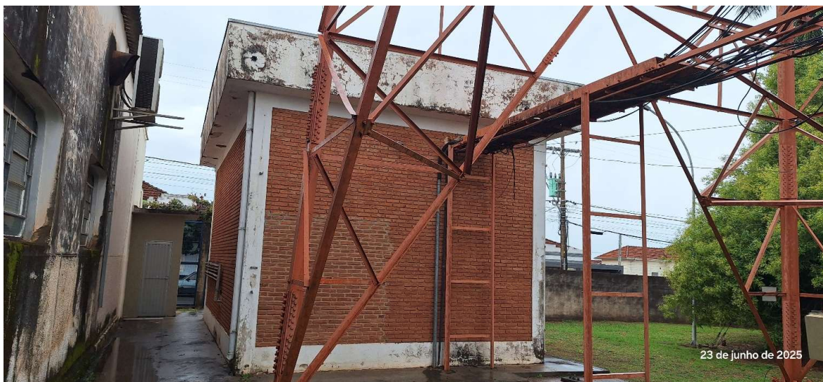
Conexão da antena com o galpão
