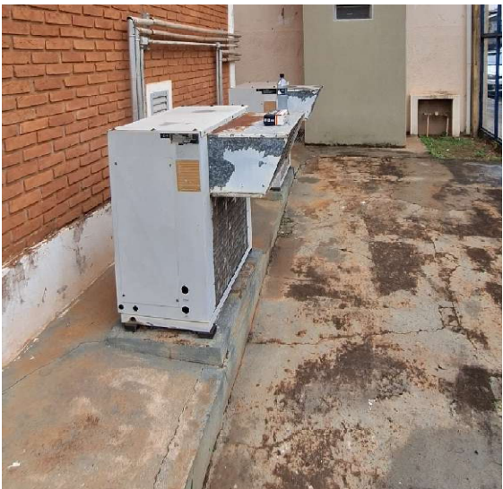
Equipamento de Refrigeração Galpão
