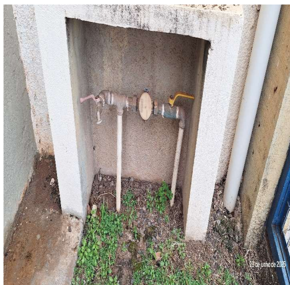
Medidor de água ausente
