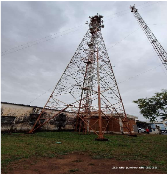
Vista Geral da Antena - Desmontavel
