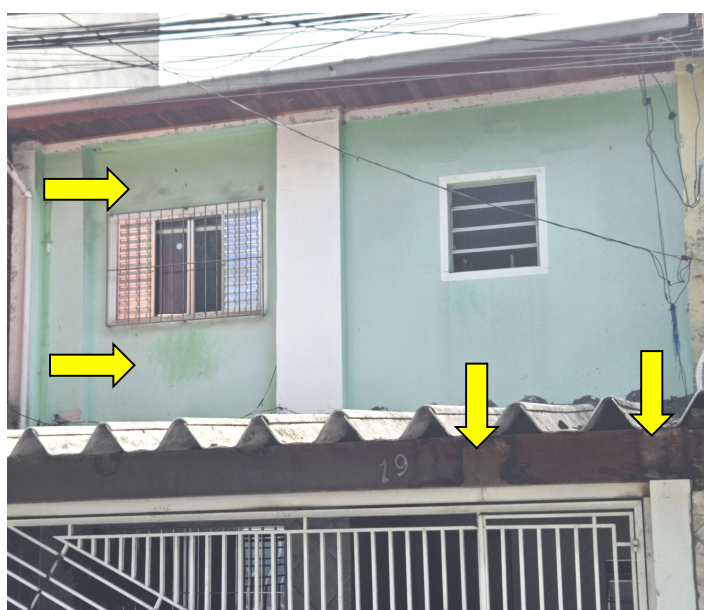
Figura 7 - Pontos de infiltração identificados e sinalizados
