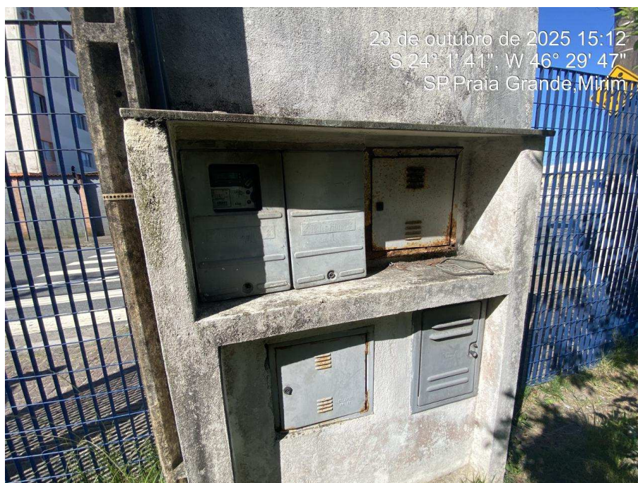
Foto 7: Vista dos medidores de energia elétrica.
