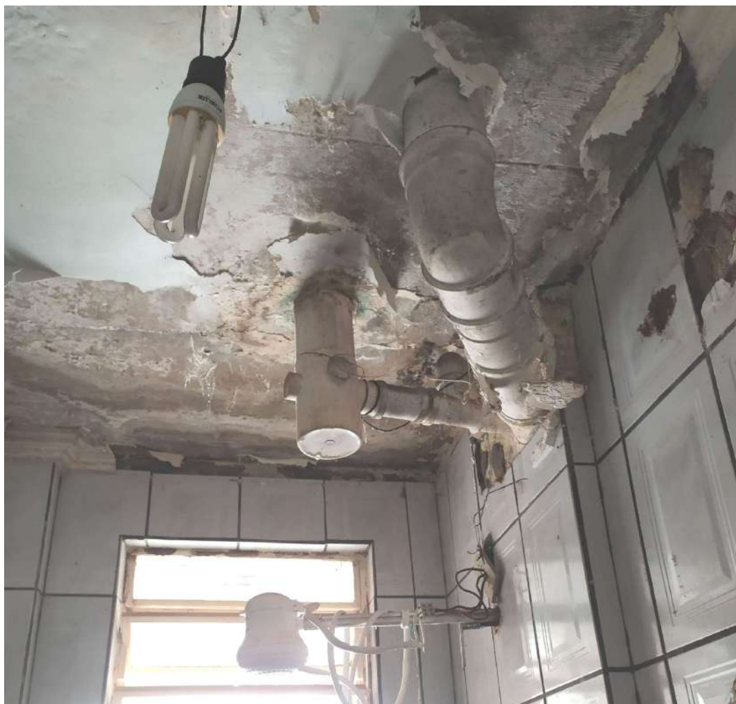
Foto 12 – Detalhe para teto do banheiro.
