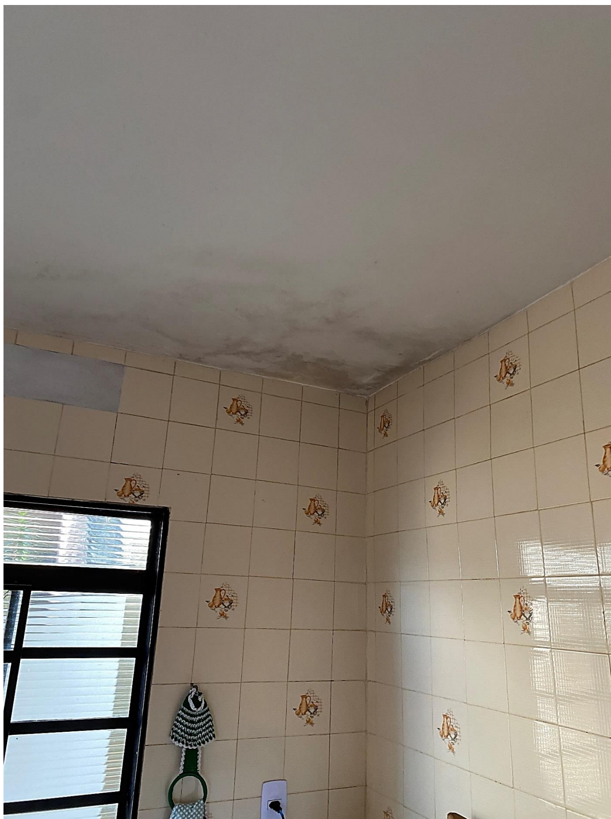
DETALHE DO TETO DA COZINHA, COM MANCHAS DE UMIDADE.
