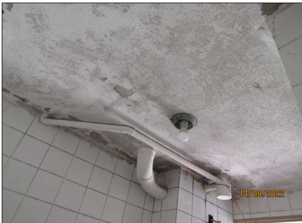
FOTO 09: Manchas de umidade no forro do banheiro.
