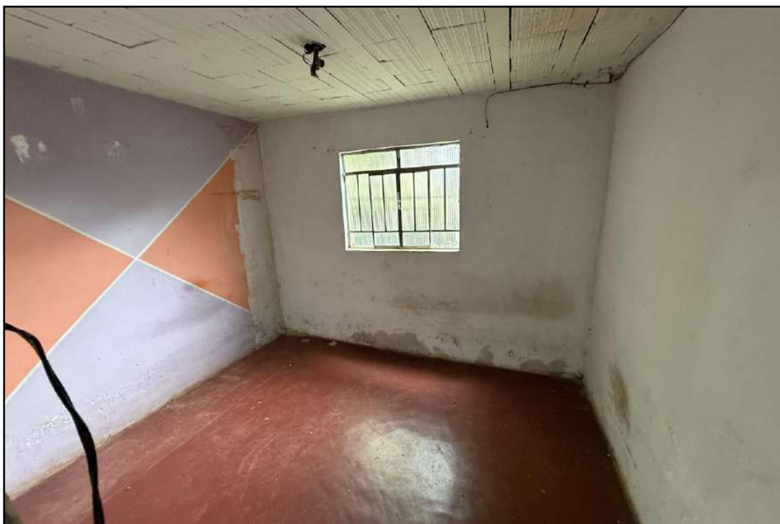
Figura 12 – Vista interna da “casa subsolo” objeto deste Laudo Pericial.
