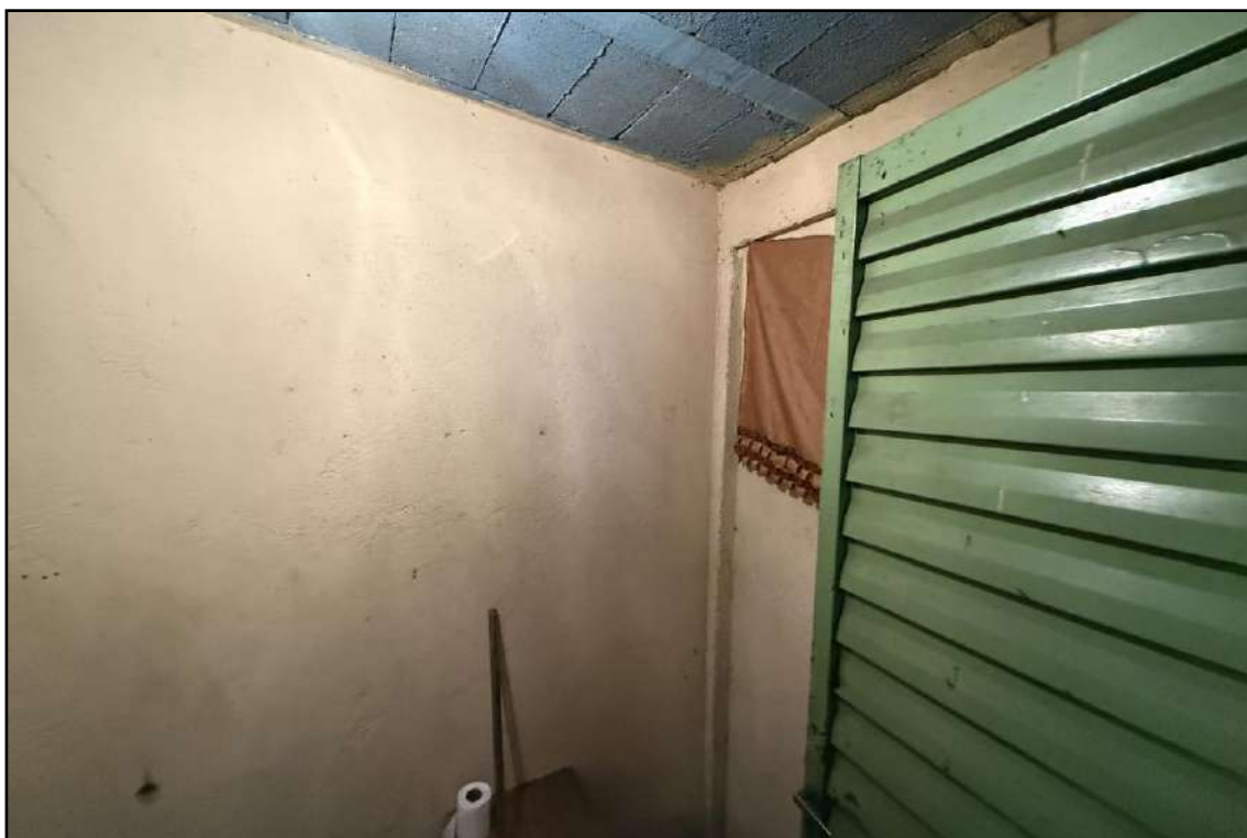
Figura 16 – Vista interna da “casa subsolo” objeto deste Laudo Pericial.
