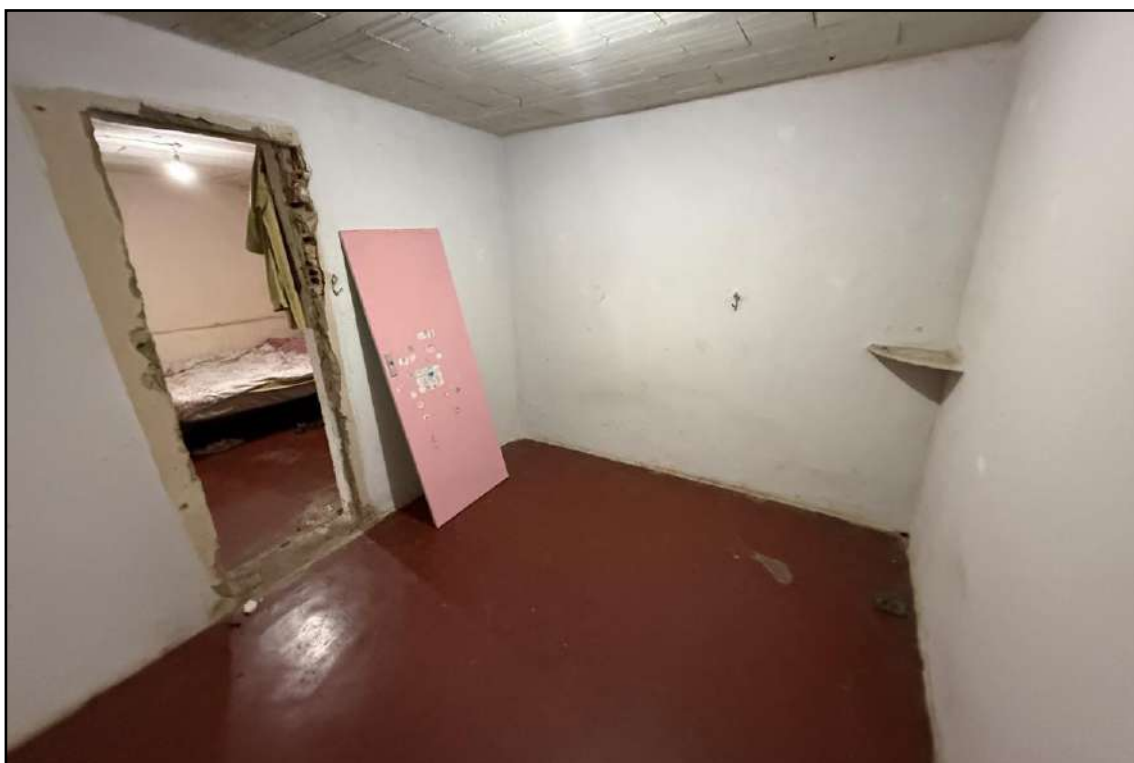
Figura 11 – Vista interna da “casa subsolo” objeto deste Laudo Pericial.
