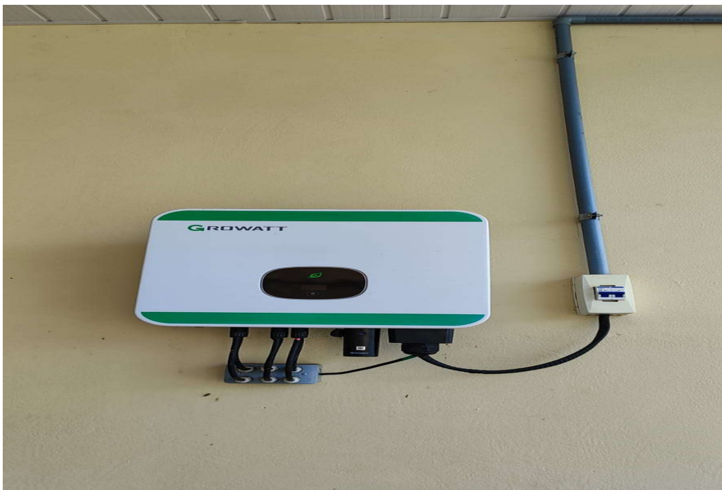
PARTE EXTERNA (FUNDOS – INVERSOR DE ENERGIA SOLAR).
