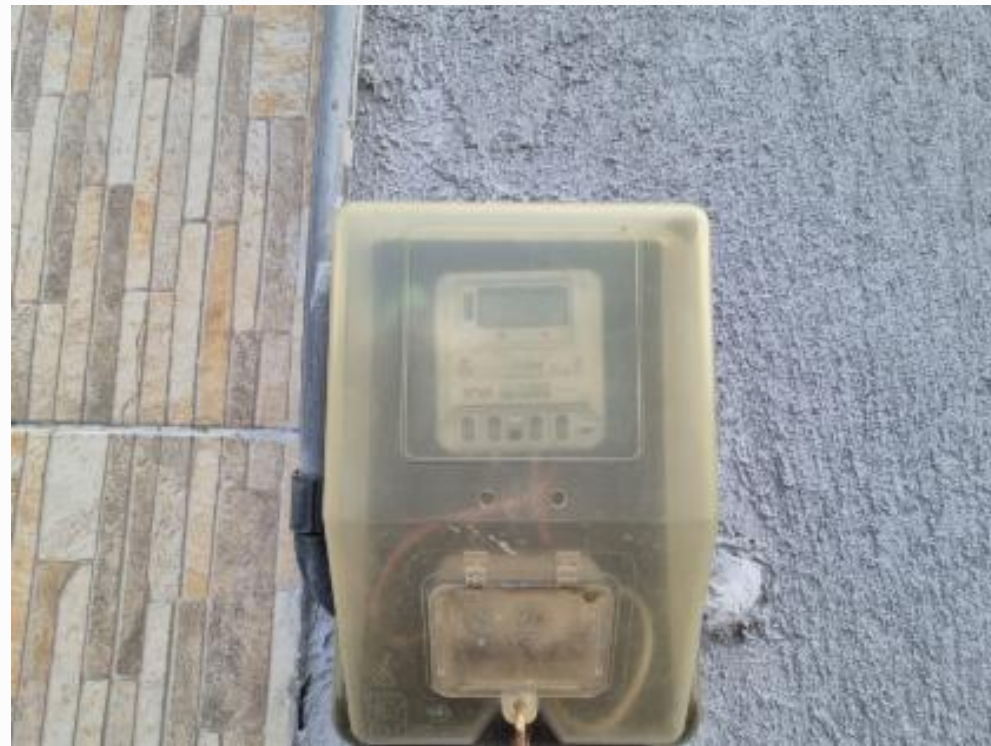
Medidor de energia
