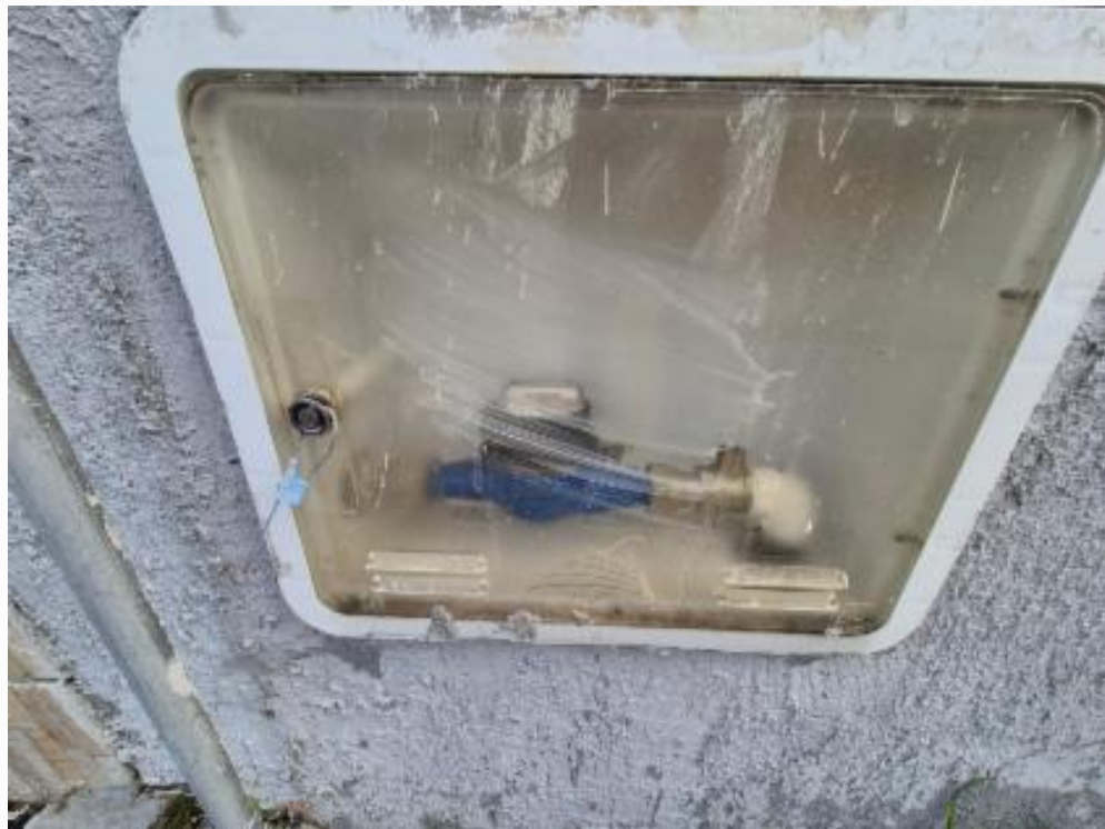
Medidor de água
