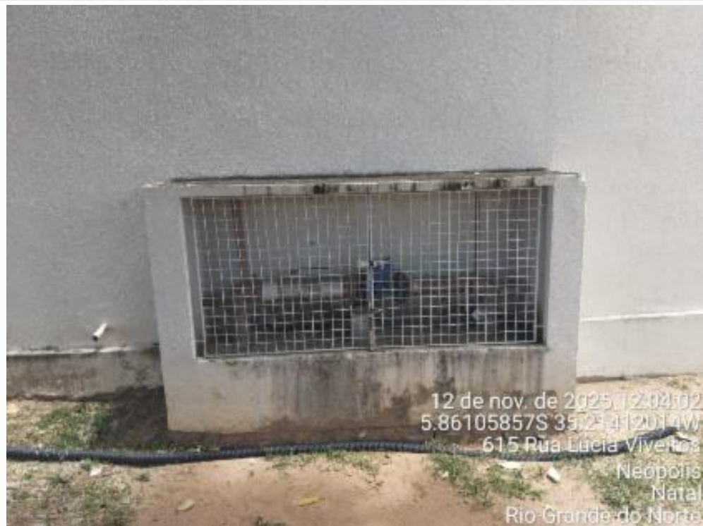
Medidor entrada de água
