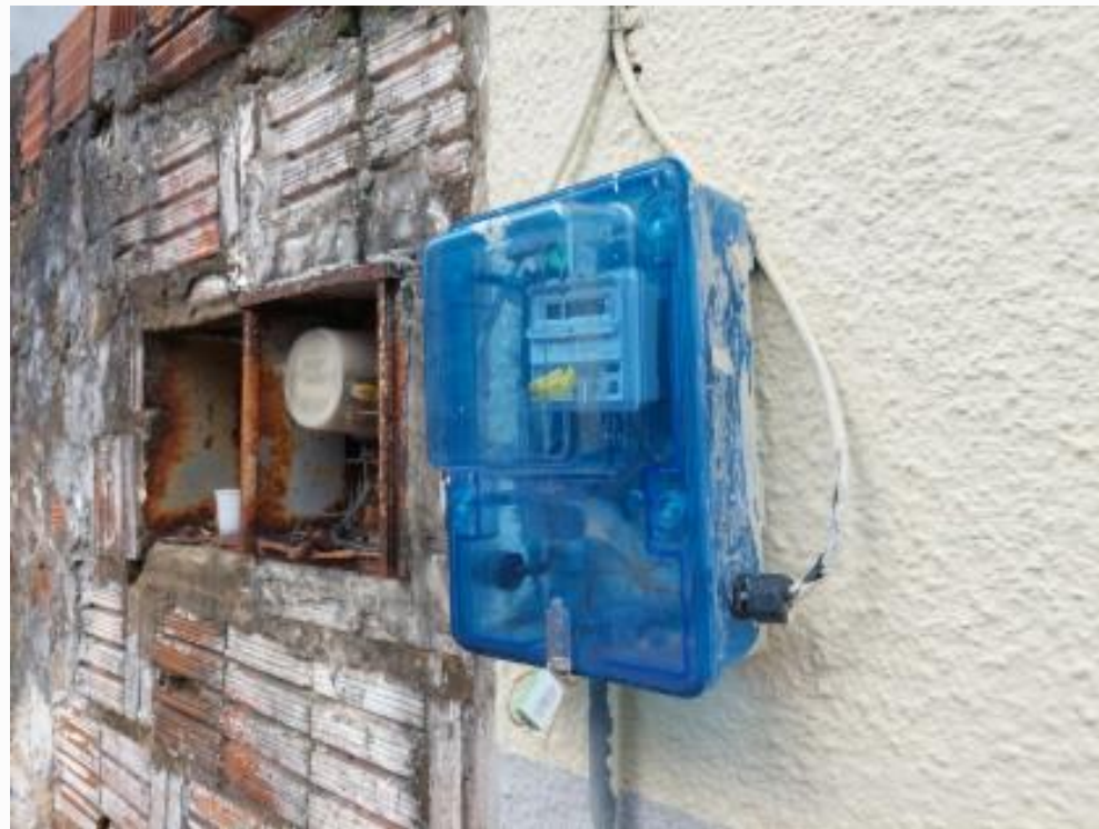
Medidor de energia
