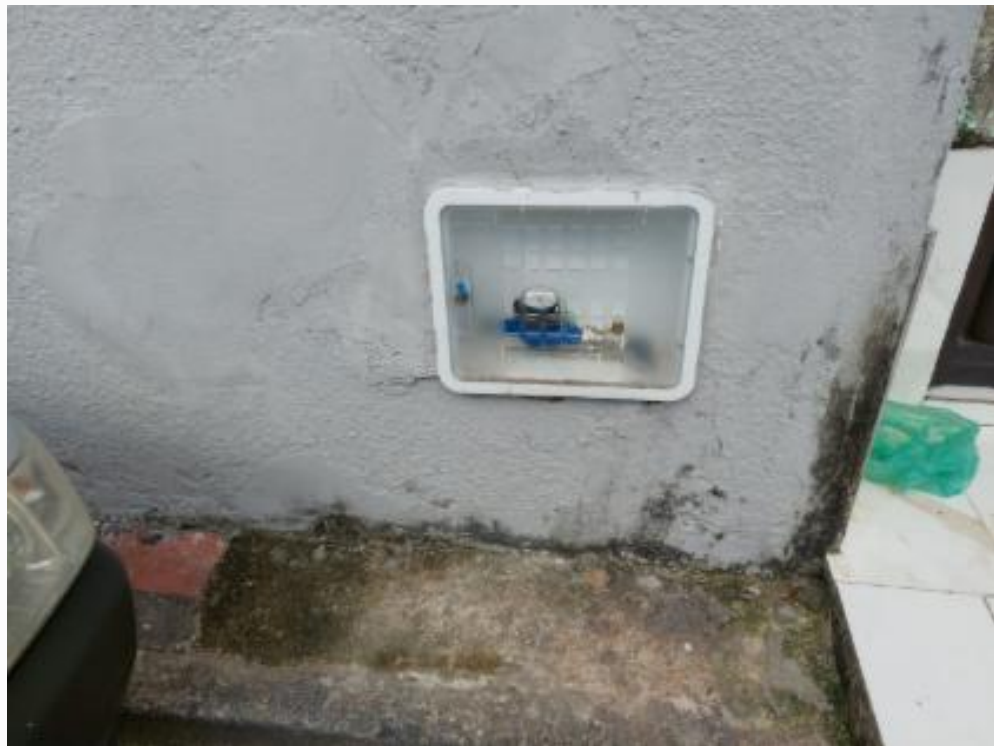
Medidor de água
