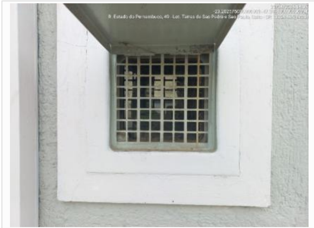
C_FOTO_10 MEDIDOR ENERGIA.jpe
