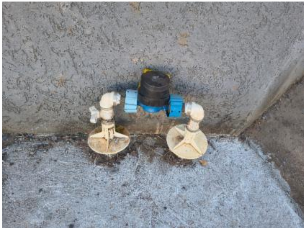
Medidor de Água
