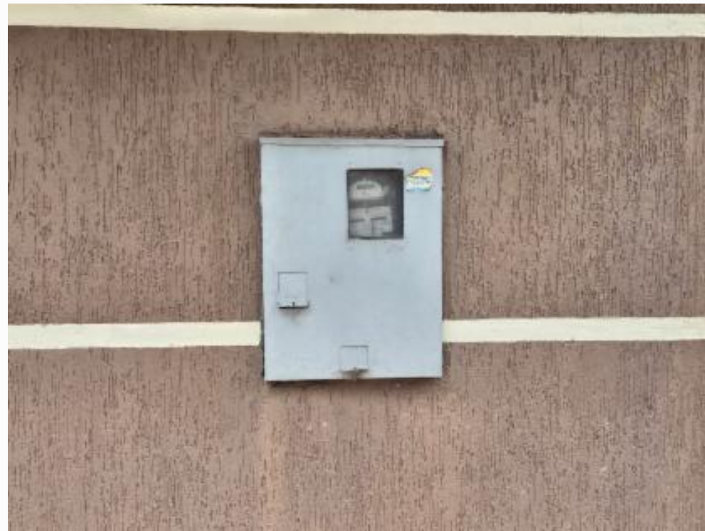
Medidor de energia
