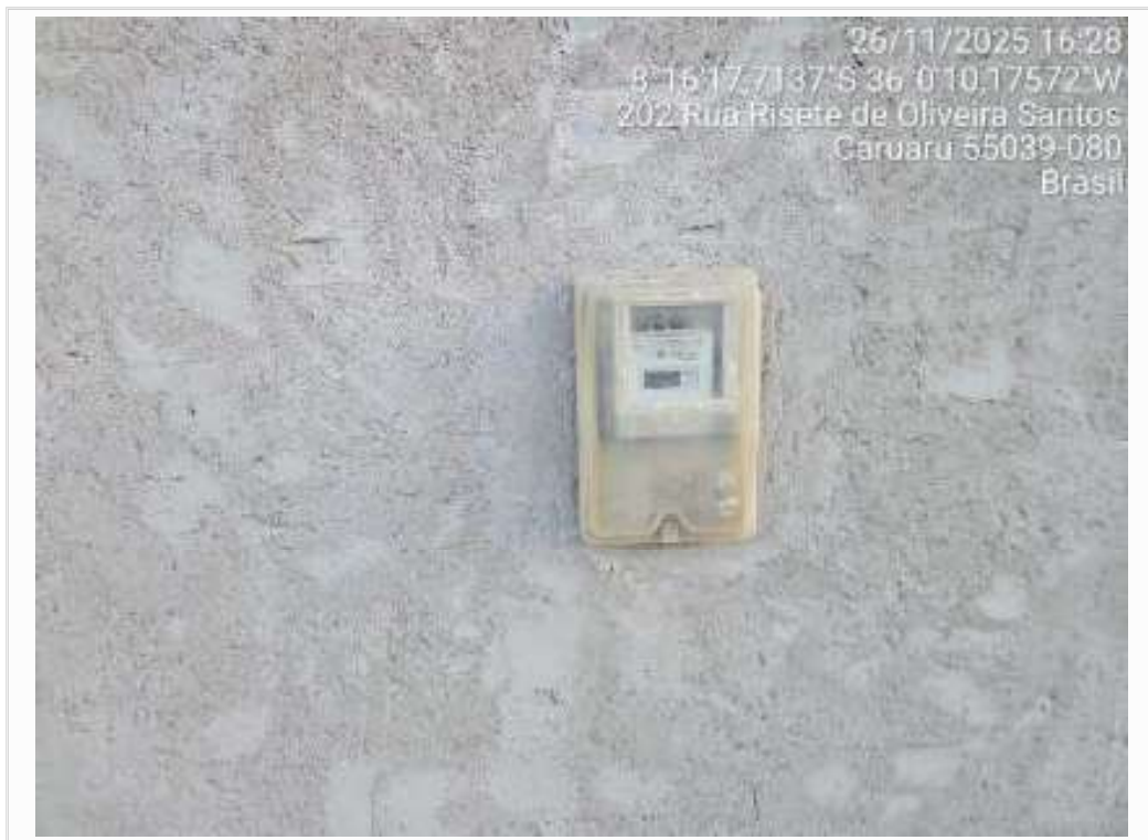
Medidor de energia
