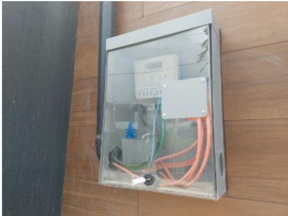
Medidor de energia
