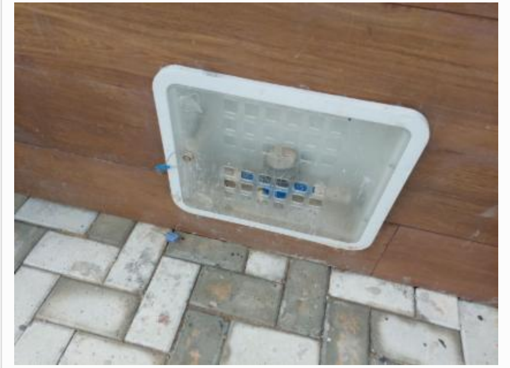
Medidor de água
