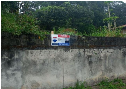
Representação Fachada Principal Descrição AMOSTRA 5 Data Foto 19/01/2024
