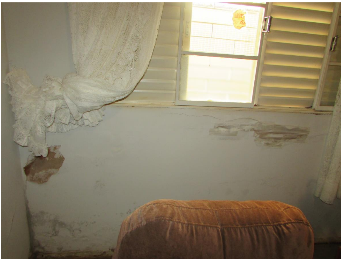
Vista de pintura e reboco danificado no dormitório.
