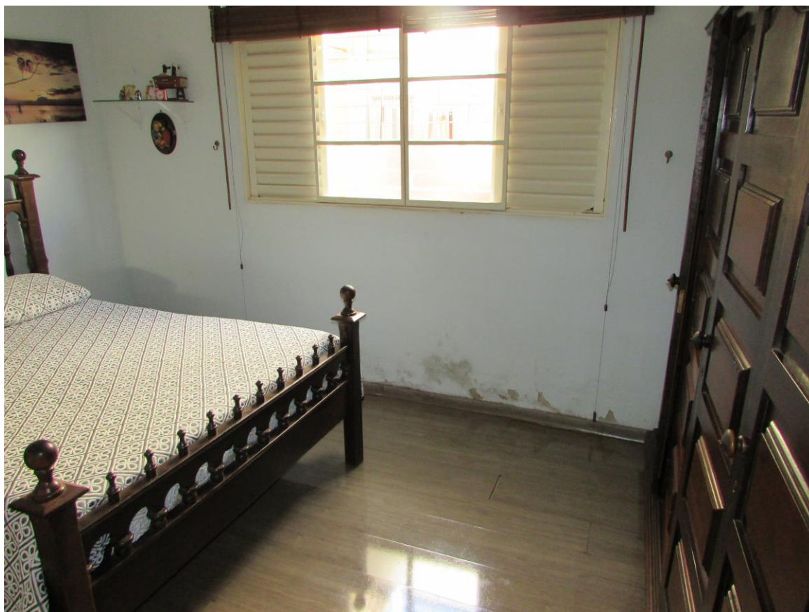
Vista de outro dormitório, pintura e reboco danificados.
