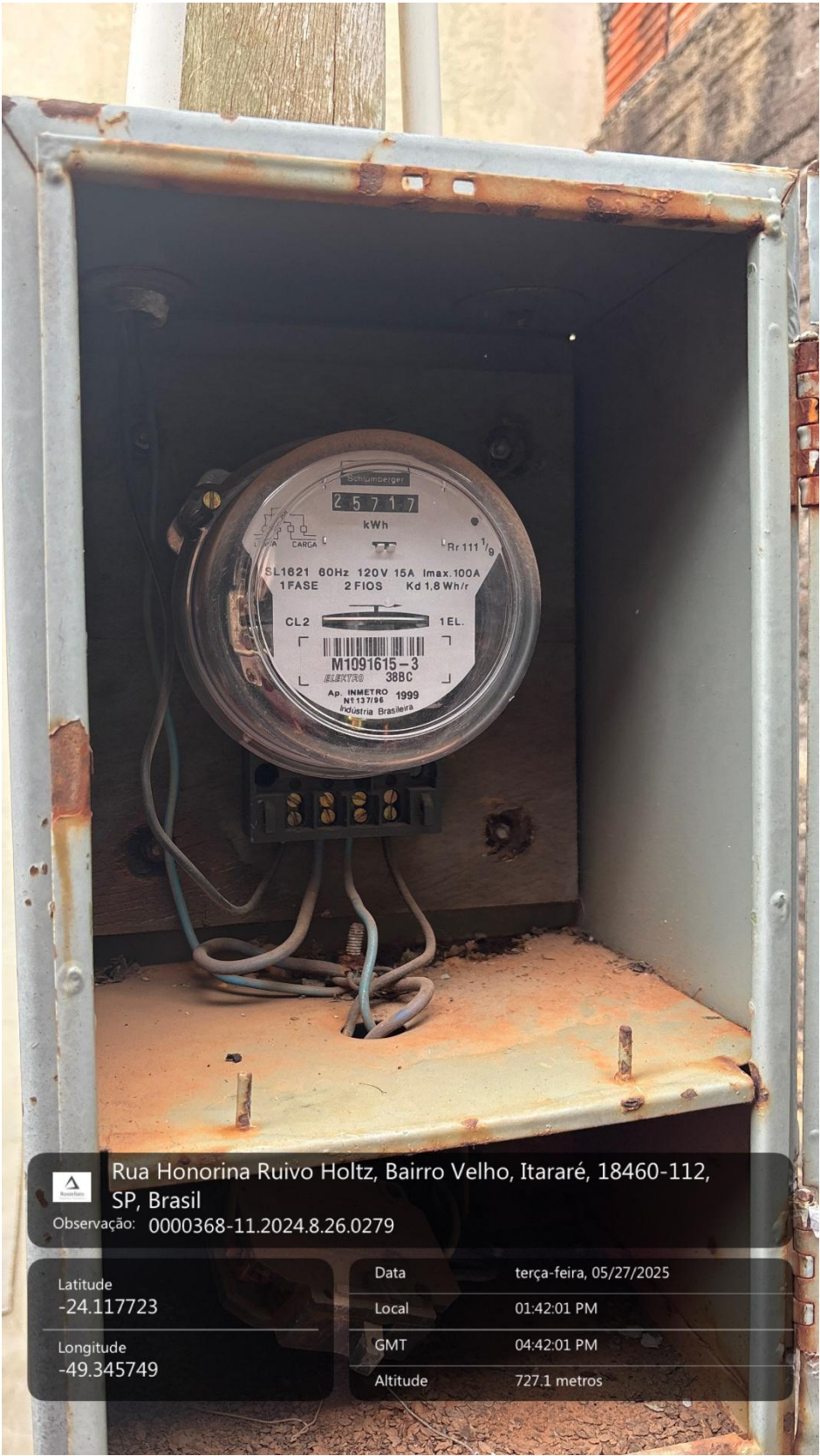
Imagem 5: Medidor de energia elétrica.
