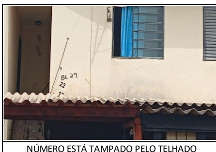
NÚMERO ESTÁ TAMPADO PELO TELHADO
