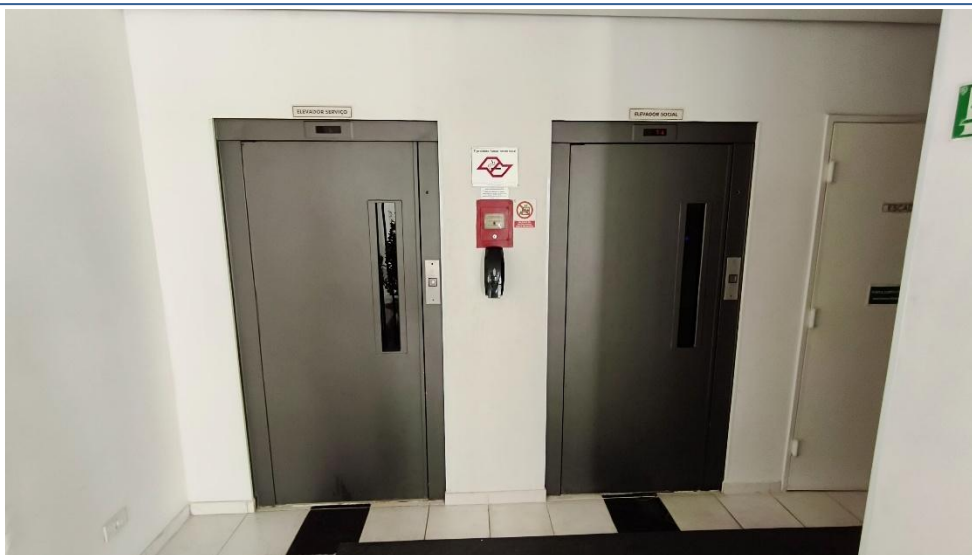
Figura 23 – Elevadores (Social e Serviço)
