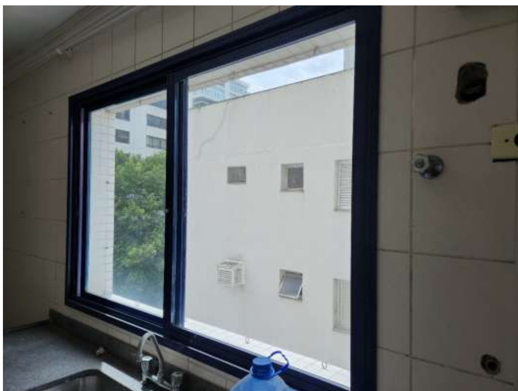
Caixilho em alumínio na cozinha.
