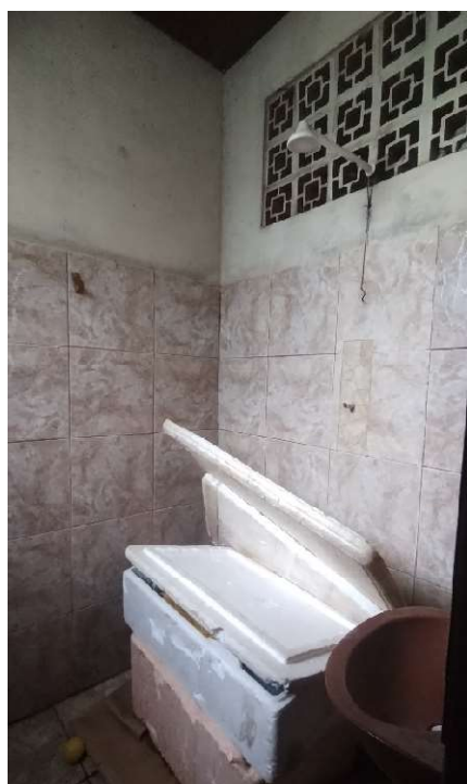
Figura 12 - W.C Suite 03 - usado como depósito
