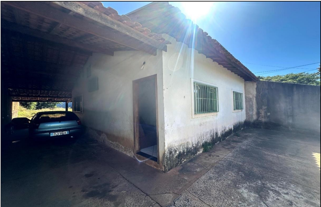
FOTO 02 – Vista geral das paredes externas com marcas de umidade do imóvel.
