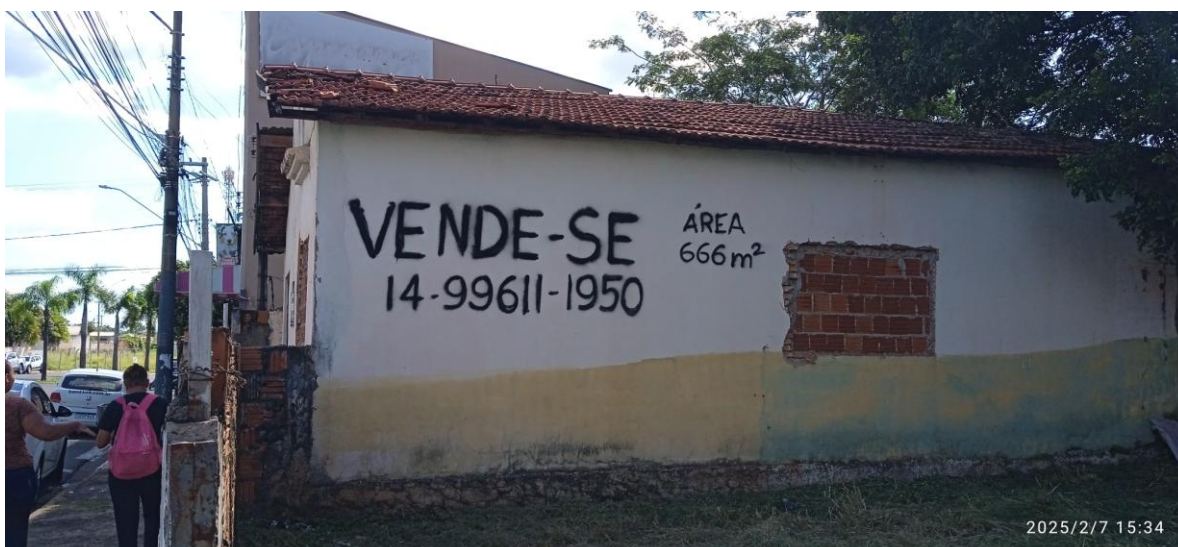
Imagem 03 - Vista parcial da fachada da residência - Cobertura danificada.
