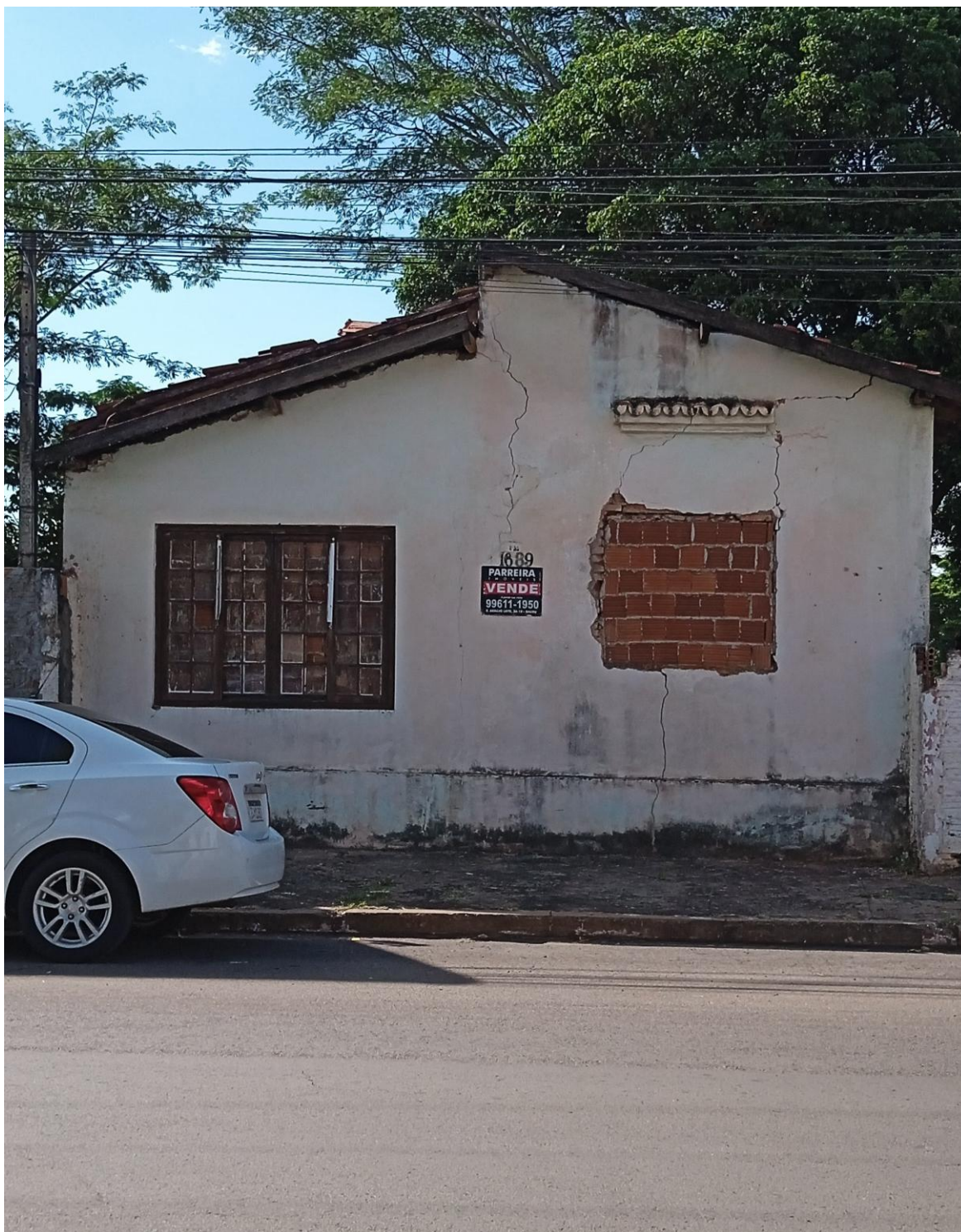
Imagem 02 - Vista parcial da fachada do imóvel - Rachaduras Estruturais.
