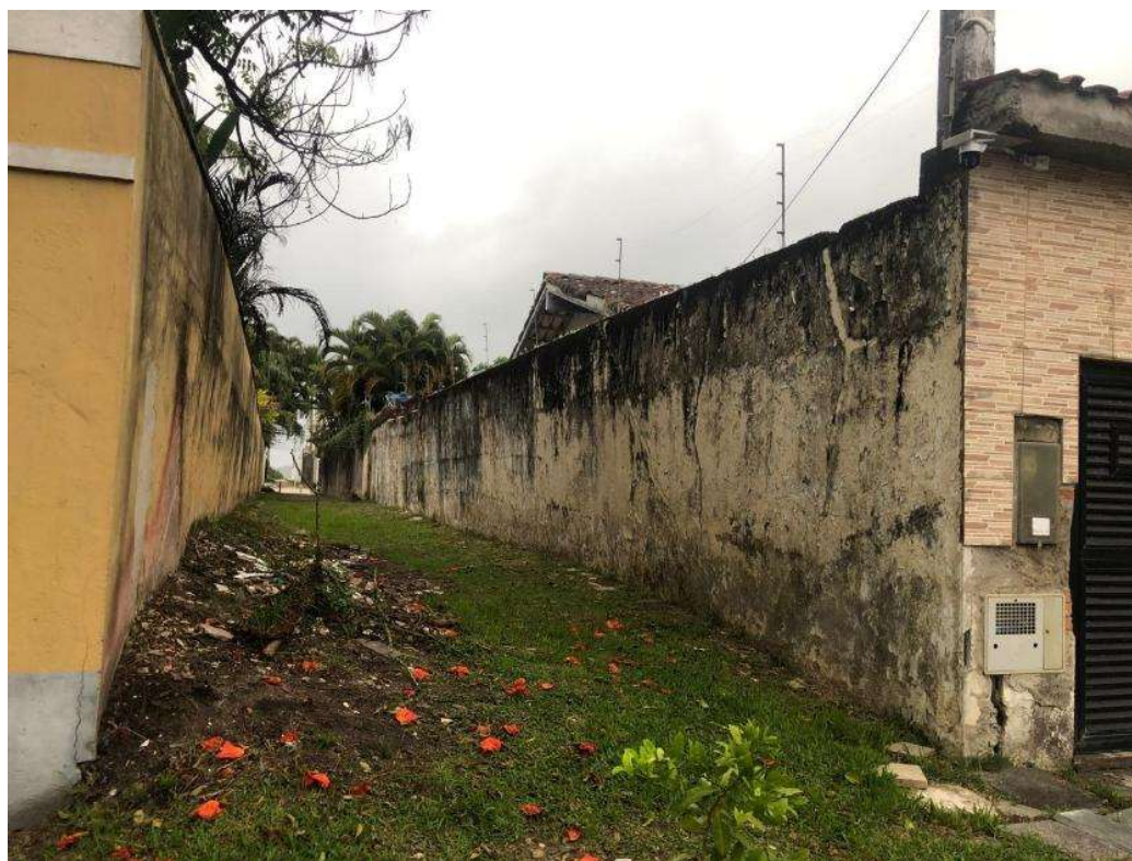
Figura 10 – Vista lateral da casa, muro fora de prumo e caminho até o mar.
