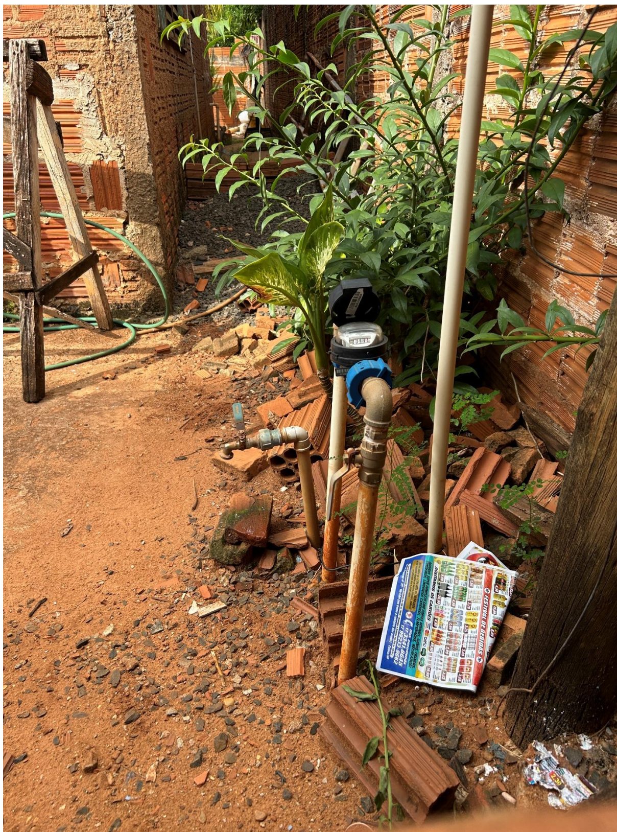
VISTA DO HIDRÔMETRO.
