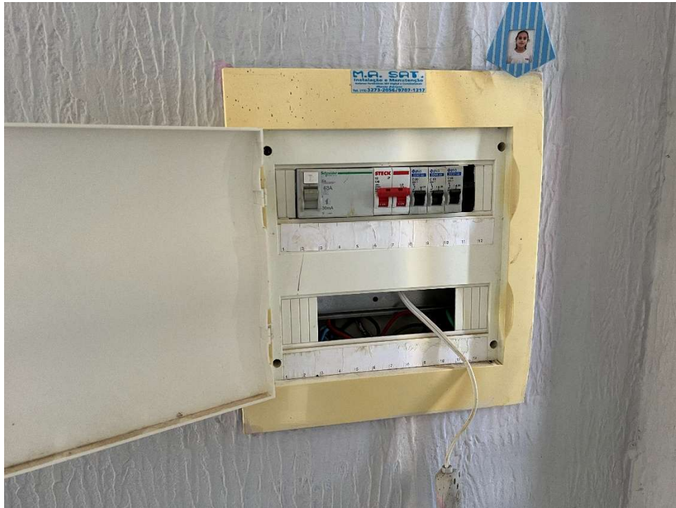
Figura 8 - Quadro de energia
