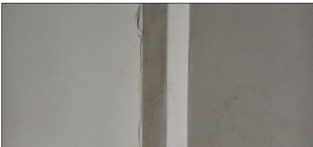
Foto 53. Fissura na Sala 312
