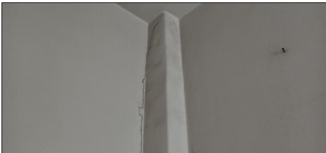
Foto 52. Fissura na Sala 312
