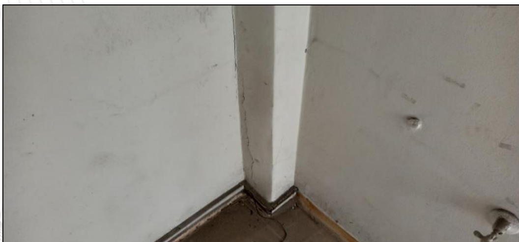
Foto 54. Fissura na Sala 312
