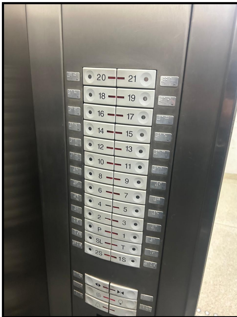
Foto nº 07 – Ilustra botoeira de comando de um dos elevadores que servem o edifício, denotando-se os pavimentos.
