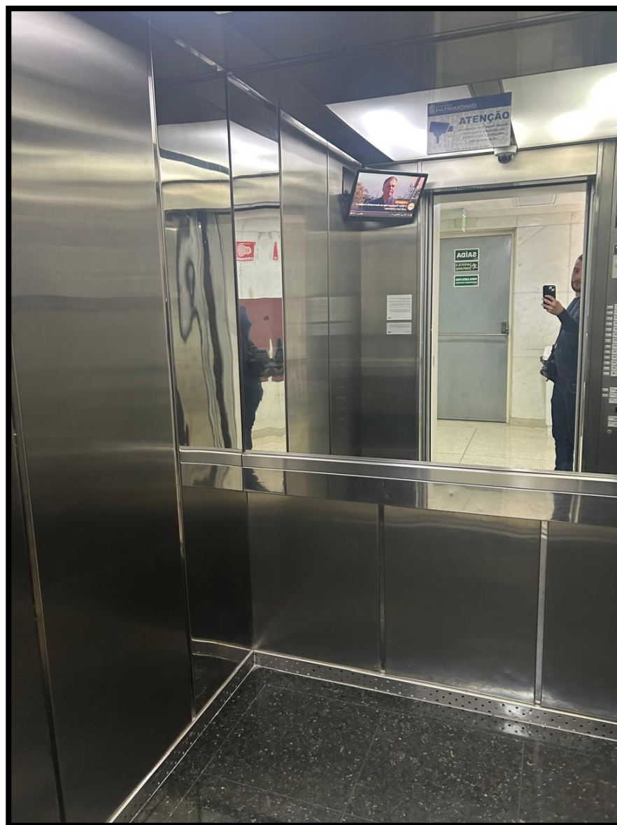
Foto nº 08 – Ilustra o interior de um dos elevadores, de quem do hall olha.
